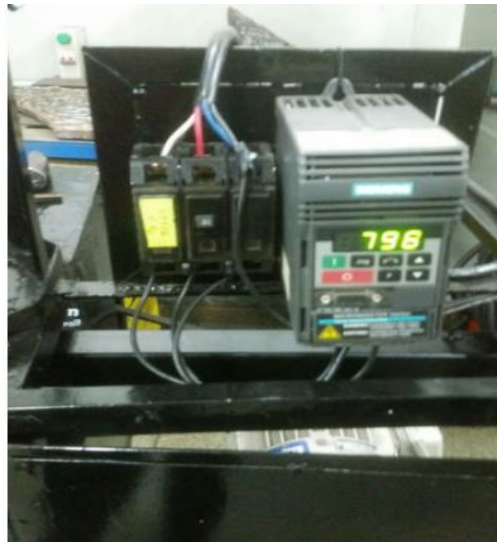
Figura 25: Inversor de frequência. Fonte: Próprio autor.
