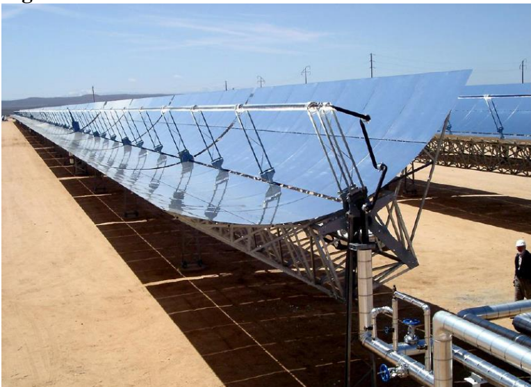
Figura 10 – Sistema de rastreamento solar
