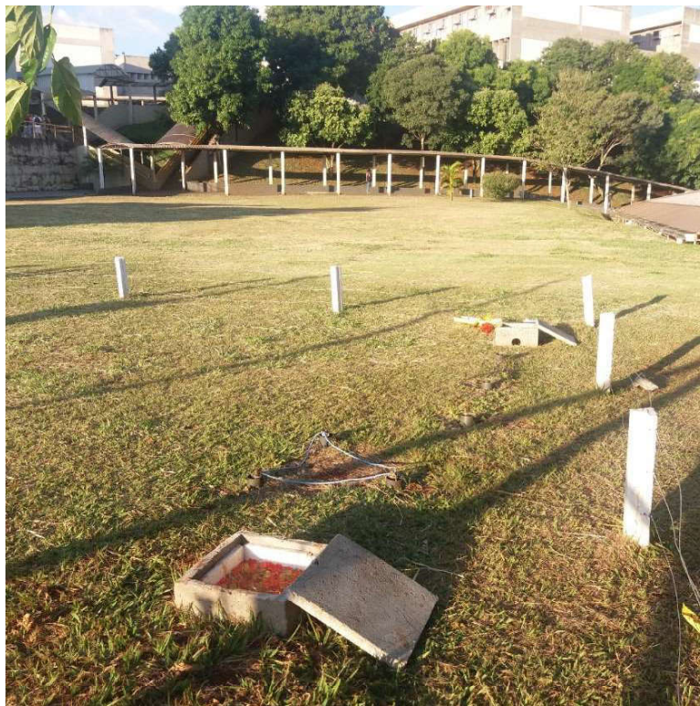
Figura 7- Os dois aterramentos instalados
