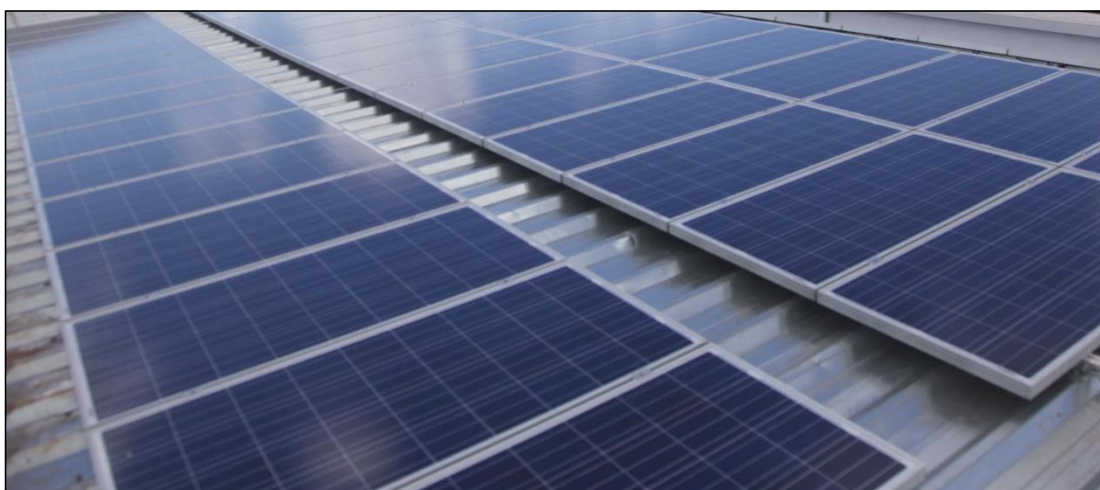
Figura 14 - Exemplo de instalação de uma placa fotovoltaica em contêiner Fonte: Neosolar Energia (2016).
