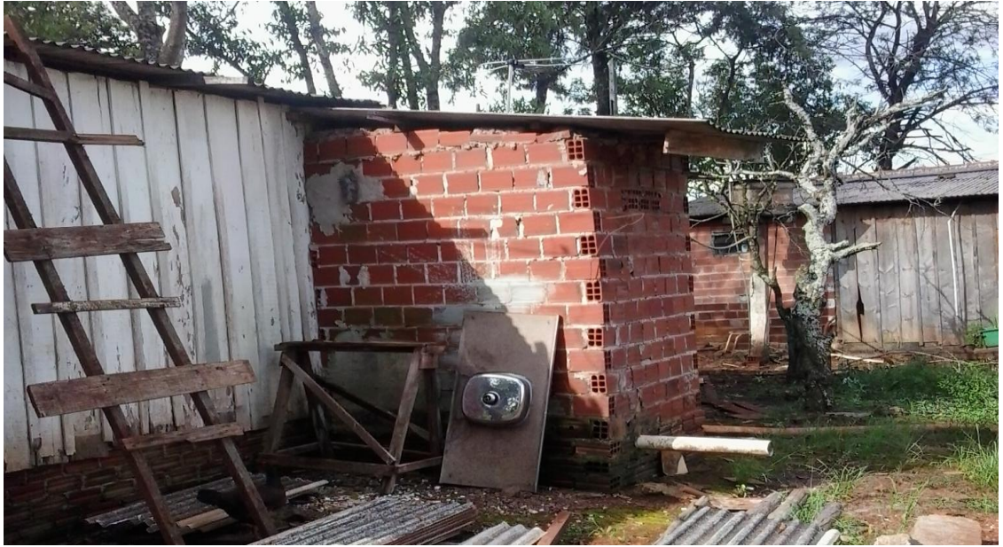
Figura 7: Banheiro com encanamento a céu aberto.
