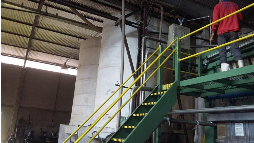
Figura 9 – Tanque de concreto onde a massa ralada fica armazenada
