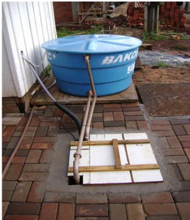
Figura 5 - Tanque de equalização. Fonte: Própria autoria, 2012.
