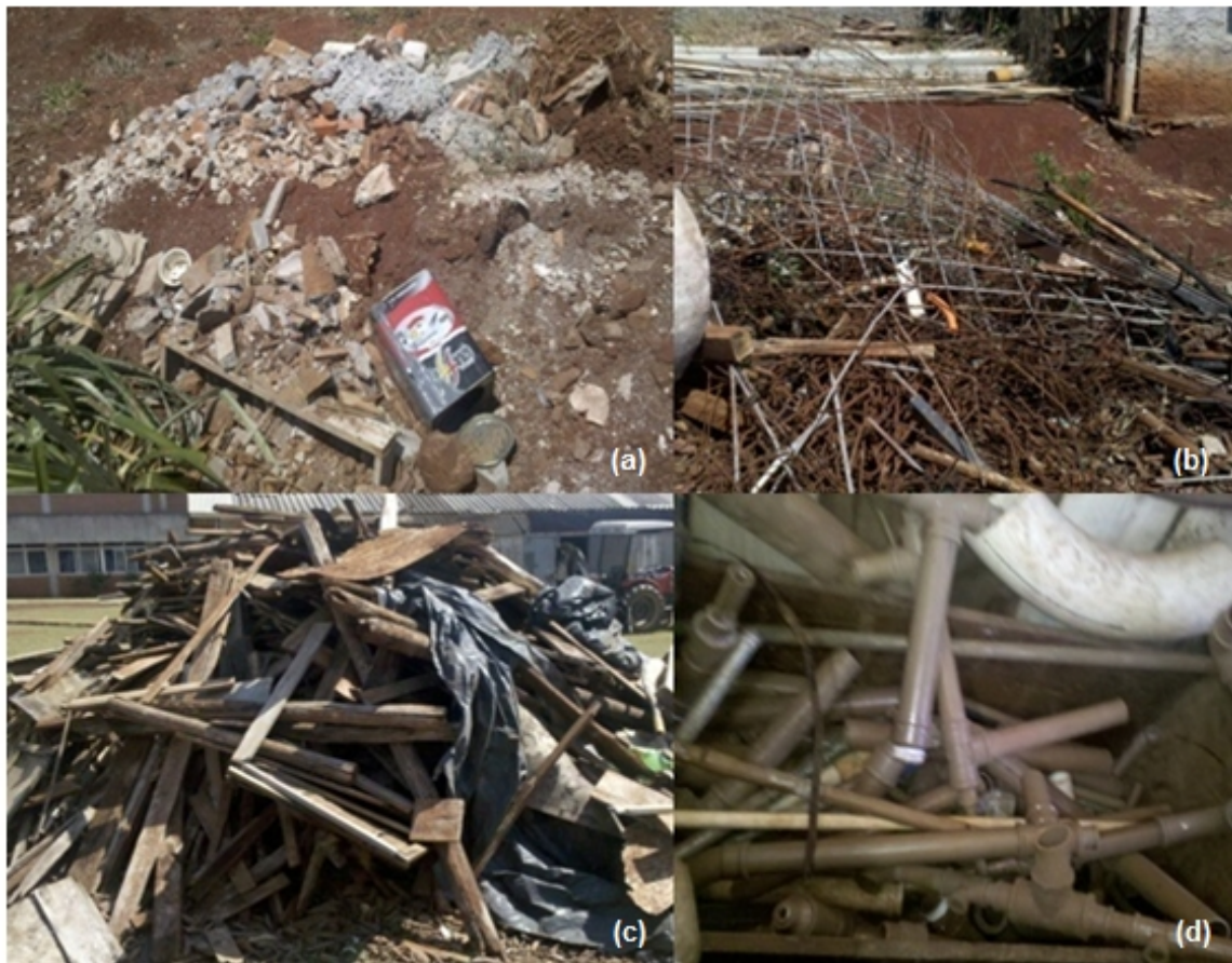
Figura 9 – Resíduos de construção civil depositados na instituição. (a) Blocos de concreto, (b) Aço e metal, (c) Pedacos de madeira, (d) tubos de PVC. Fonte: Autoria própria.
