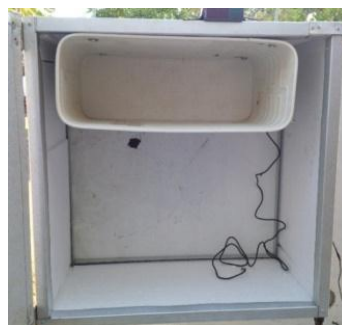
Figura 28: Evaporador fixado na câmara fria.
