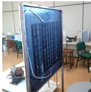
Figura 27: Condensador acoplado ao módulo.
