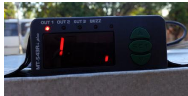
Figura 30: Controlador de temperatura.
