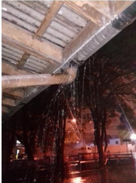
Foto 3: Transbordo por mau dimensionamento. Fonte: Autoria própria, 2016
