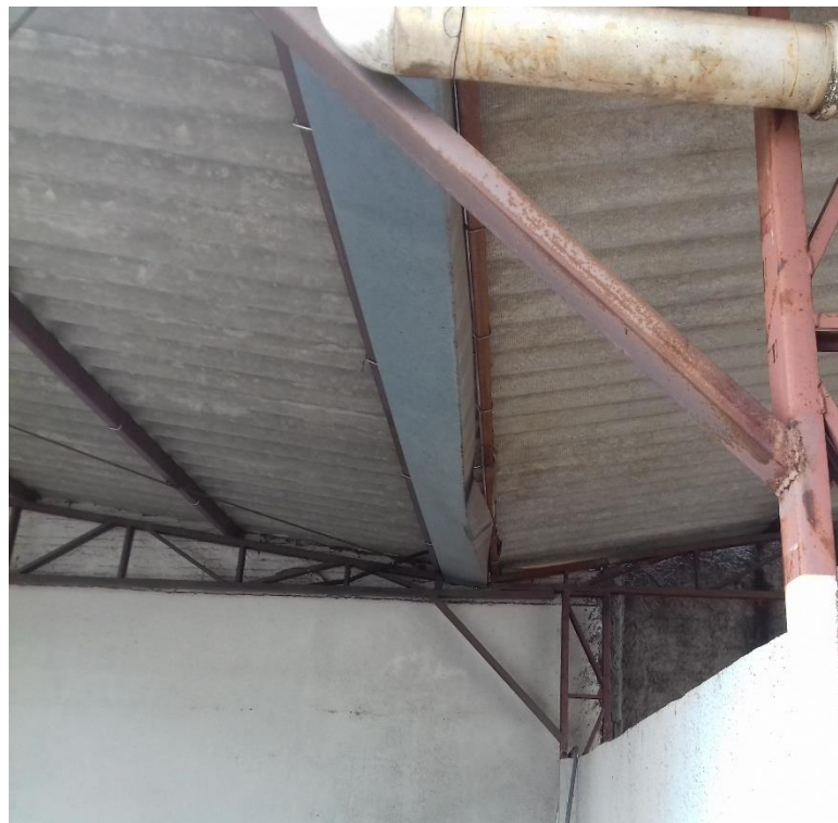
Foto 5: Deformação lateral da calha Fonte: Autoria própria, 2016
