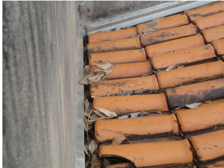
Foto 11: Calha com folhas obstruindo a passagem da água Fonte: Autoria própria, 2017
