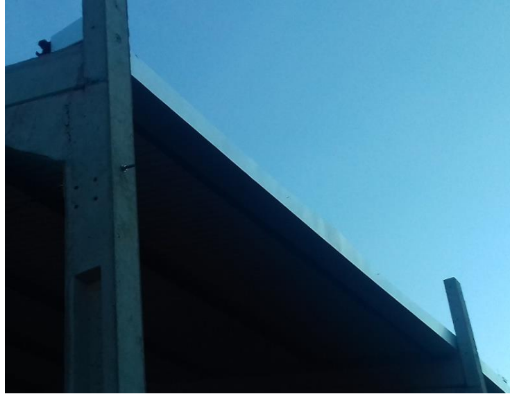
Foto 6: Deformação lateral da calha Fonte: Autoria própria,2017
