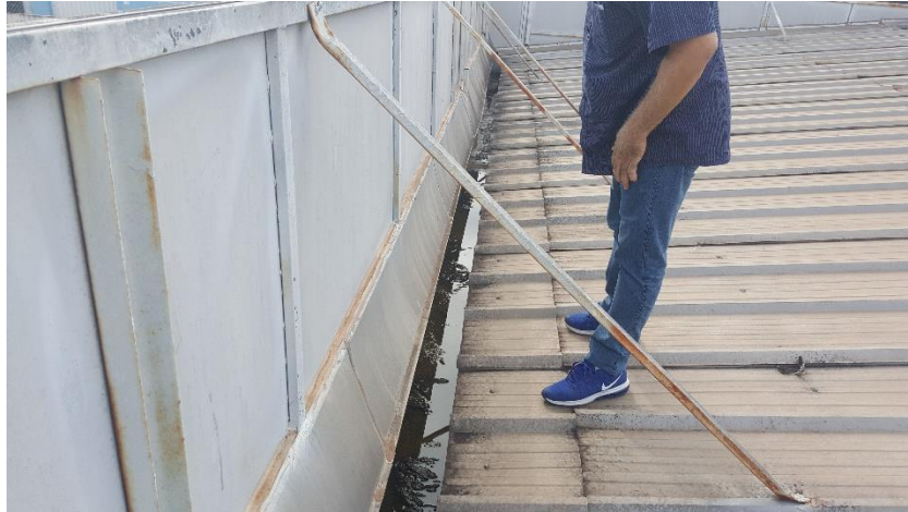
Foto 10: Calha com declividade errada Fonte: Autoria própria, 2017
