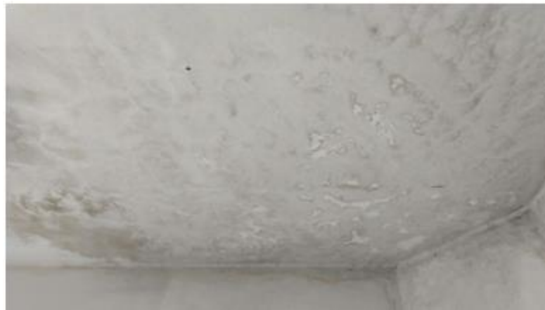
Foto 1: Manchas no teto devido à infiltração na calha Fonte: Autoria própria, 2016
