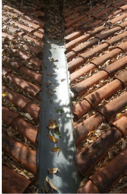
Foto 15: Calha com falta de manutenção para retirada de folhas Fonte: Autoria própria, 2017
