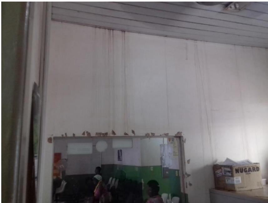
Foto 17: Infiltração proveniente de calha Fonte: Autoria própria,2017
