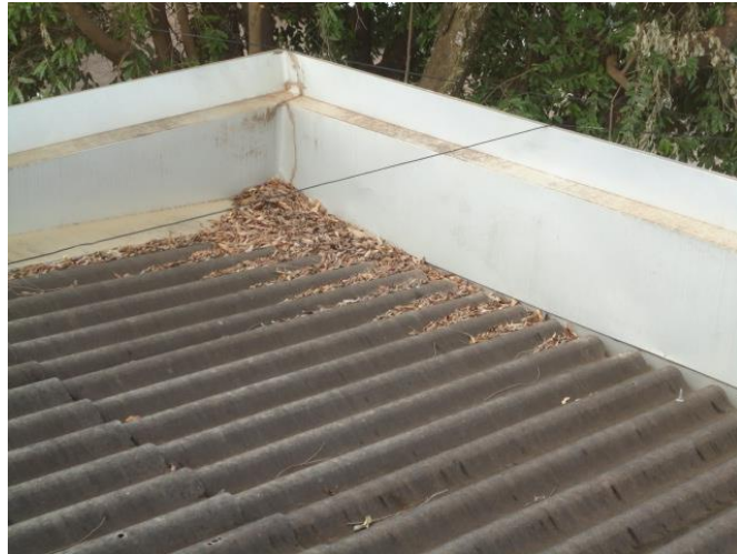
Foto 13: Acumulo de folhas na calha Fonte: Autoria própria, 2017
