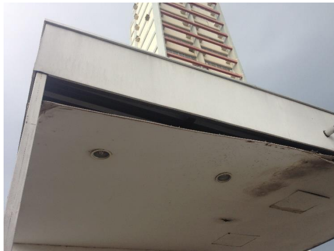
Foto 9: Forro soltando devido a infiltração da calha Fonte: Autoria própria, 2017
