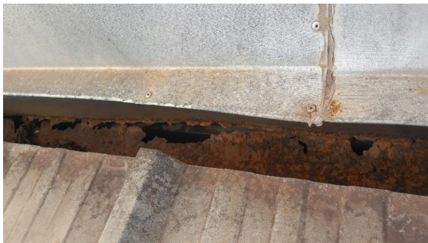
Foto 16: Calha com corrosão Fonte: Autoria própria, 2017
