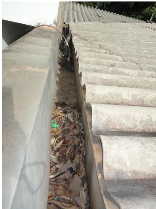
Foto 12: Calha com problema de obstrução Fonte: Autoria própria, 2017
