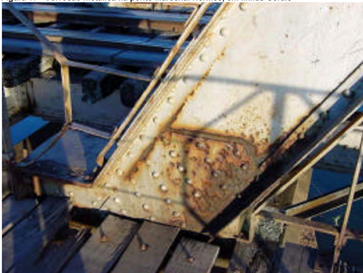
Figura 17 - Corrosão metálica na ponte Marechal Hermes, em Minas Gerais
