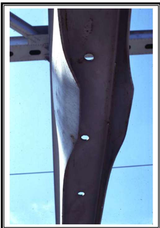
Figura 29 - Flambagem lateral em membro estrutural da Ponte do Rio Mississippi, em Minnesota
