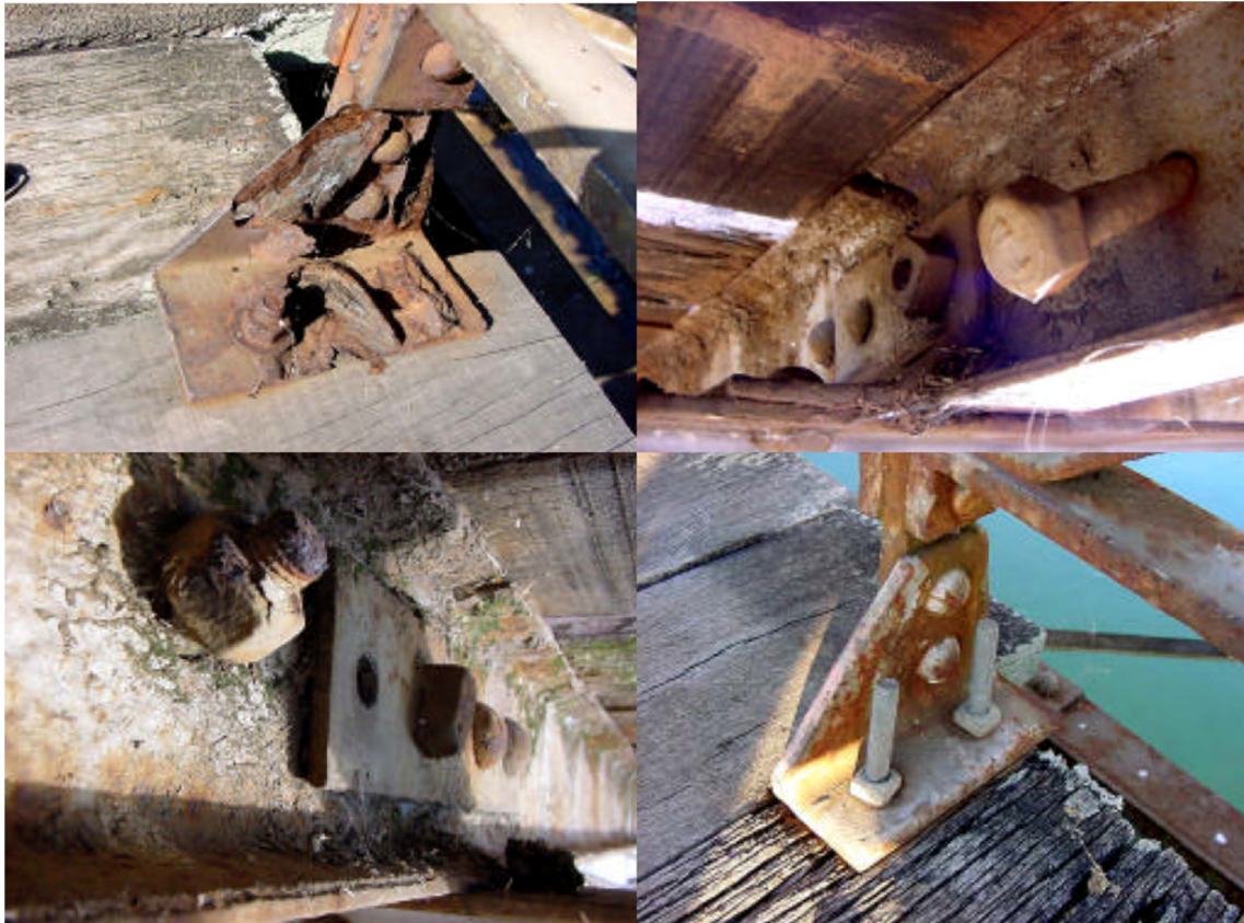
Figura 42 - Problemas corrosivos em ligações por parafusos em uma ponte metálica
