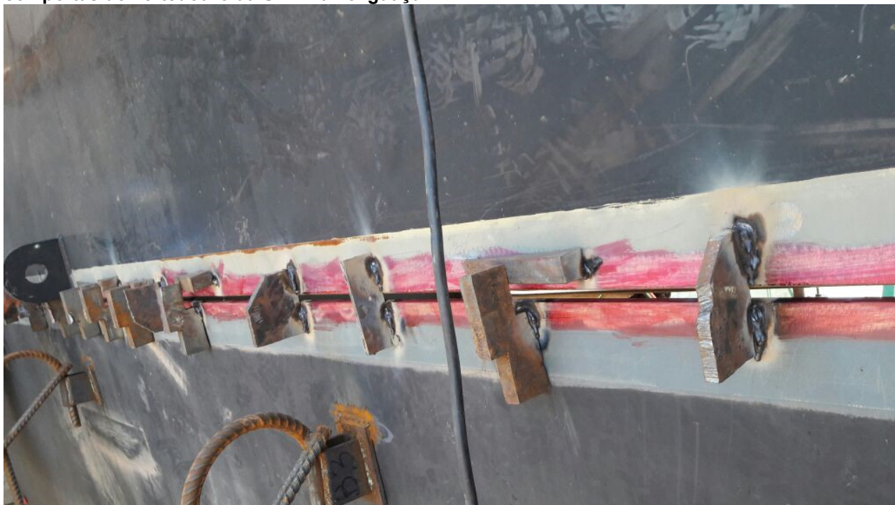
Figura 41 - Realização do Teste de LP em soldagem entre elementos constituintes de uma das comportas do vertedouro da UHE Baixo Iguaçu
