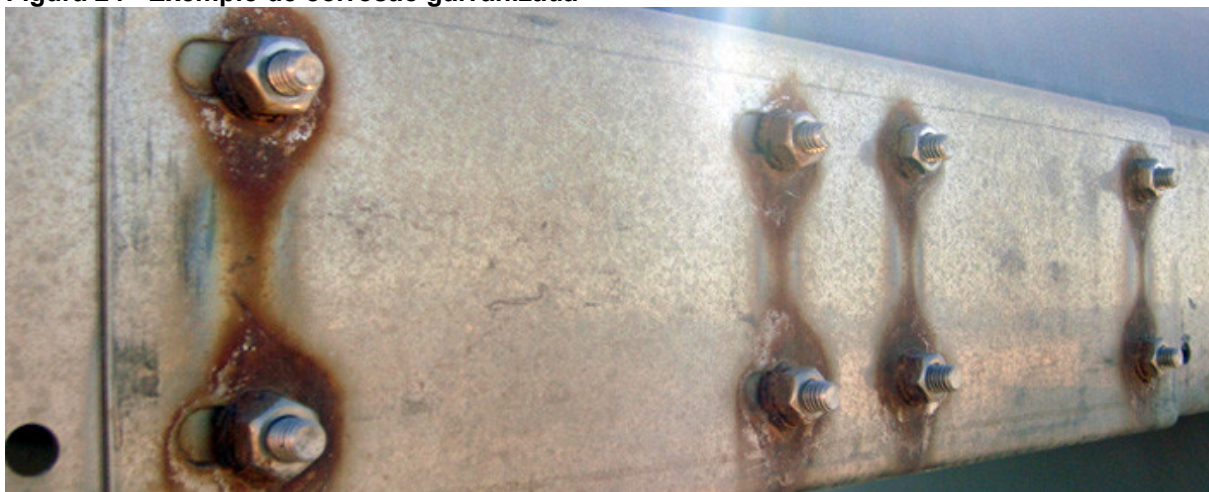
Figura 24 - Exemplo de corrosão galvanizada
