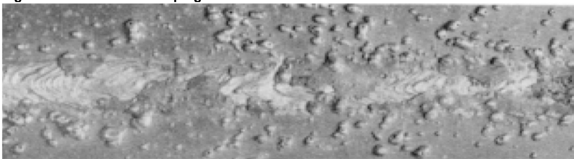
Figura 38 - Excesso de respingos de solda
