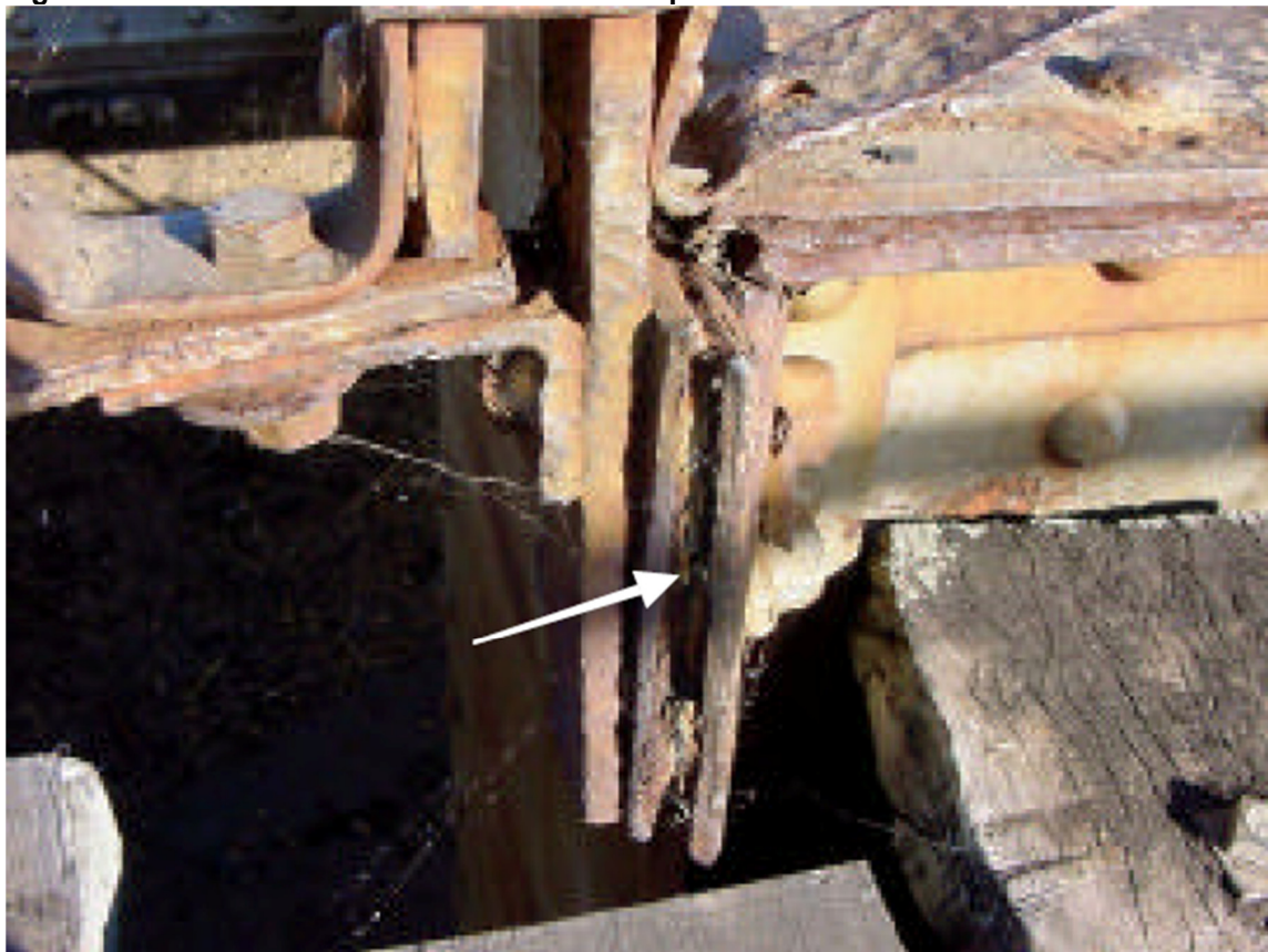
Figura 21 - Corrosão em frestas encontrada na ponte Marechal Hermes
