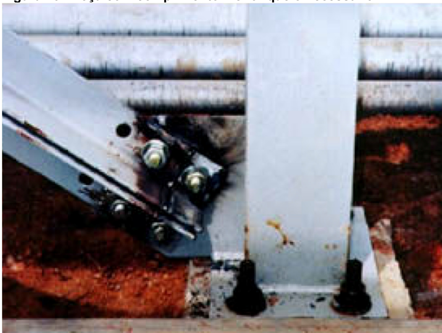
Figura 43 - Peça com comprimento menor que o necessário
