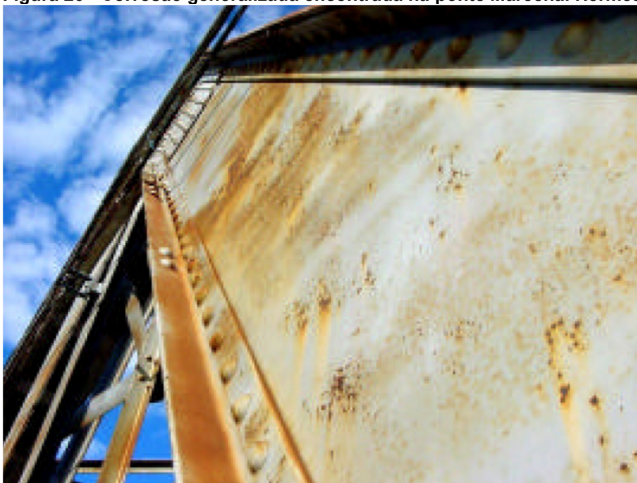
Figura 20 - Corrosão generalizada encontrada na ponte Marechal Hermes
