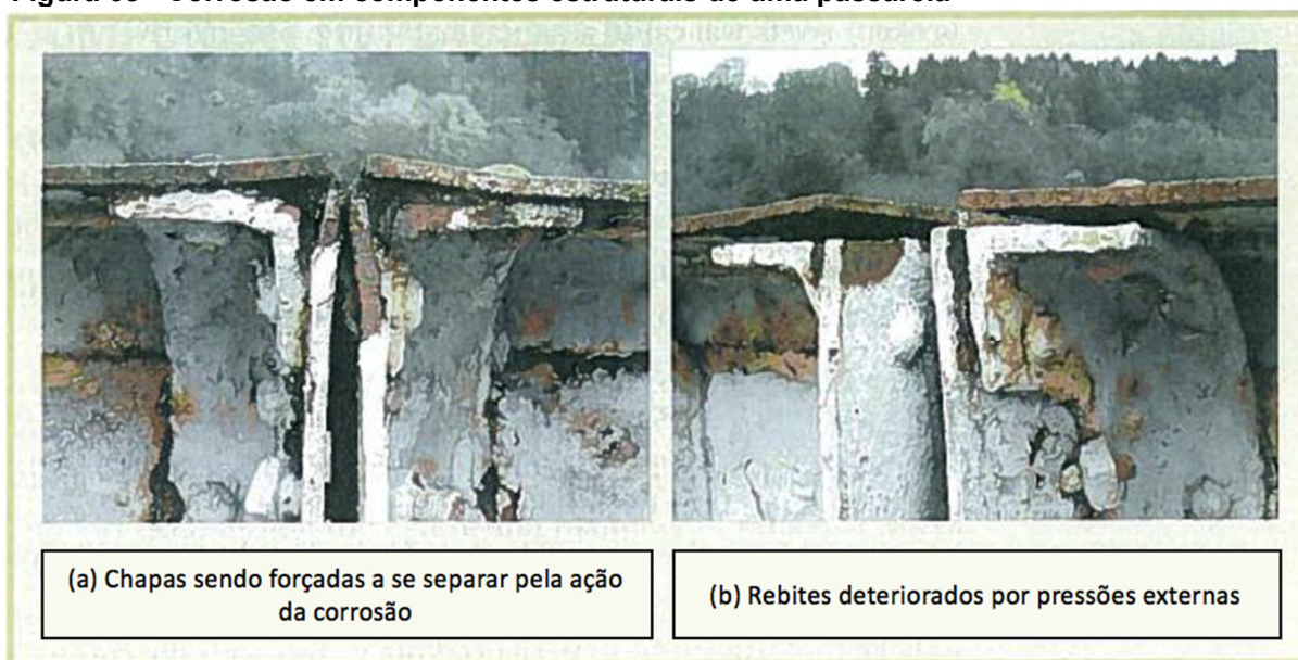
Figura 68 - Corrosão em componentes estruturais de uma passarela
