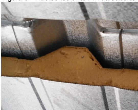
Figura 6 – Núcleo isolante PIR da cobertura B.
