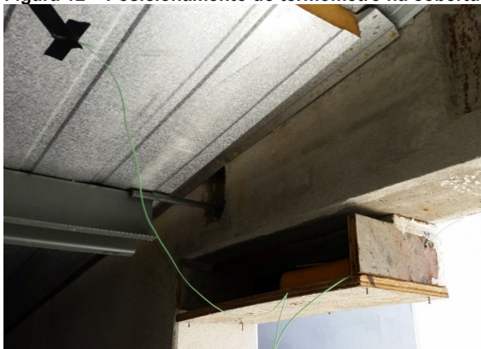
Figura 12 – Posicionamento do termômetro na cobertura B.
