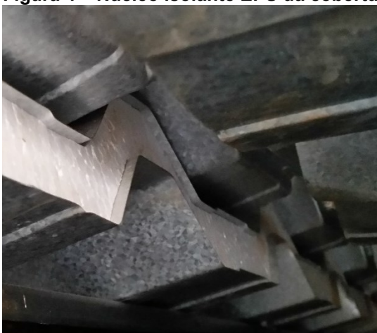
Figura 4 – Núcleo isolante EPS da cobertura A.
