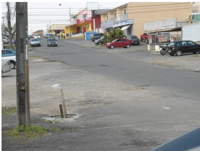
Figura 18 - Trecho da via com infraestrutura precária Fonte: Autoria própria.
