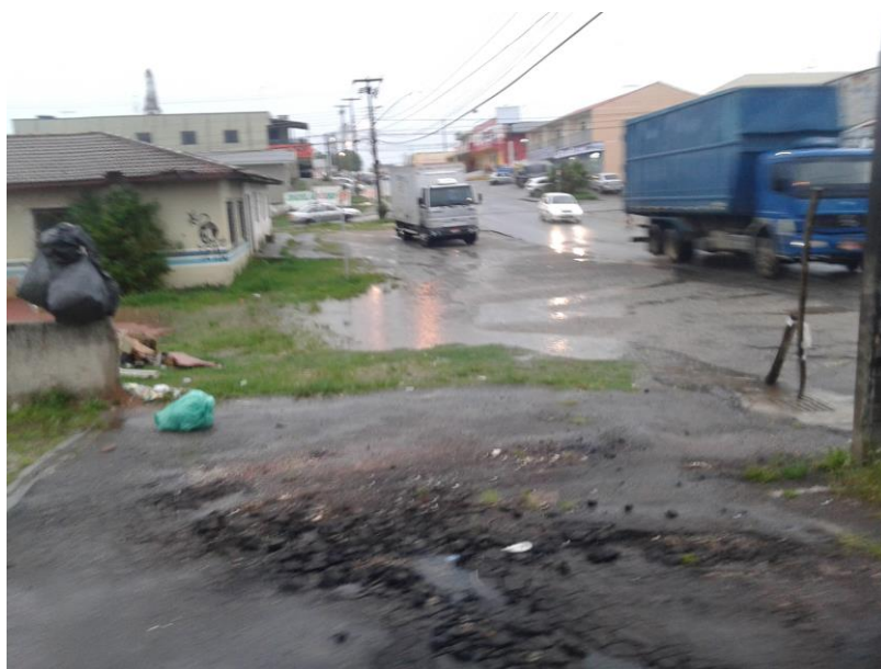
Figura 21 - Dificuldade de escoamento das águas pluviais da via Fonte: Aatoria própria.
