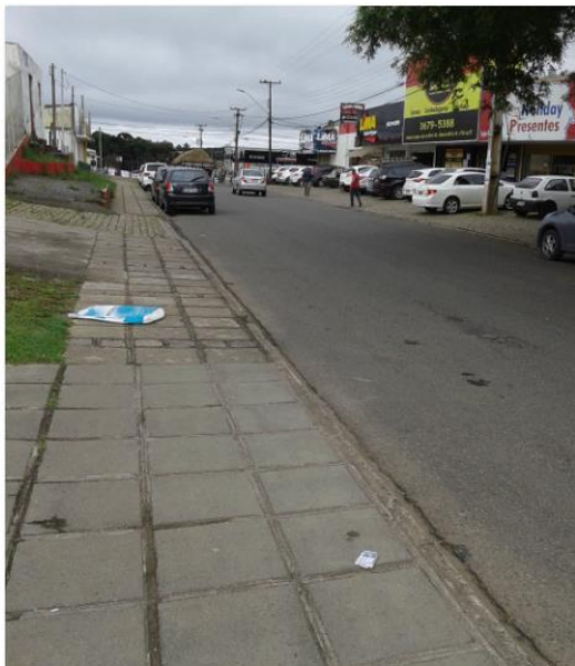
Figura 24 - Conflito do espaço destinado a pedestres com veículos em estacionamentos de 90° Fonte: Autoria própria.
