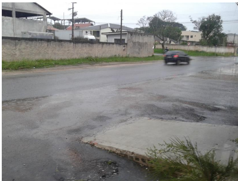
Figura 20 – Escoamento das águas pluviais irregulares na Rua José Sbalchieiro Fonte: Aatoria própria.
