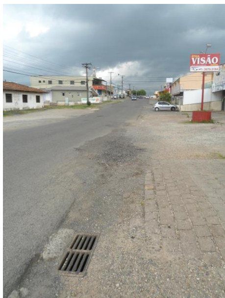
Figura 22 - Irregularidades no pavimento da via Fonte: Autoria própria.
