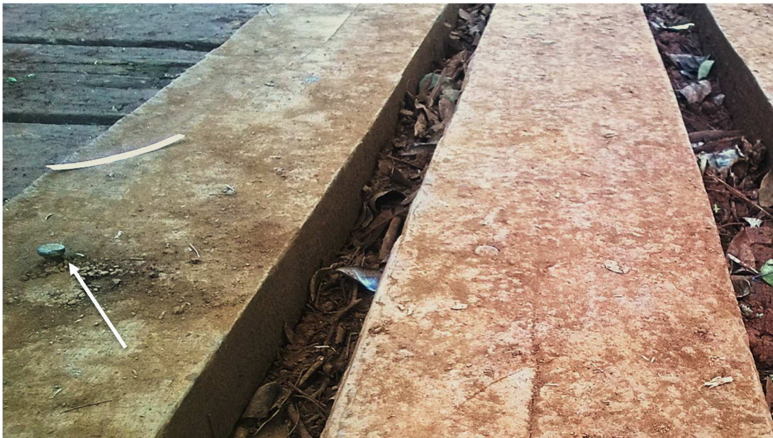
Fotografia 6 – Desgaste por corrosão e afrouxamento dos pregos de aço Fonte: O autor (2015).
