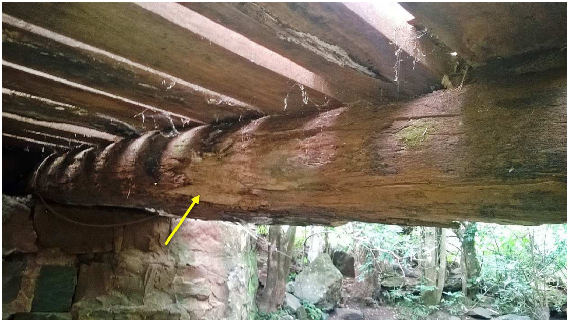
Fotografia 14 – Desprendimento de partes apodrecidas da viga B Fonte: O autor (2015).
