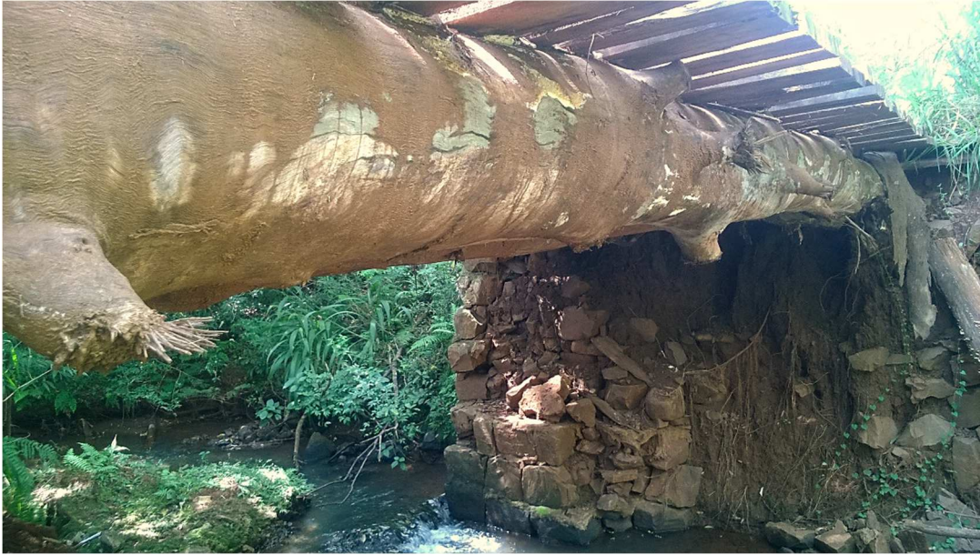
Fotografia 27 – Cabeceira em pedra argamassada destruída, vigas apoiadas sobre o solo Fonte: O autor (2015).
