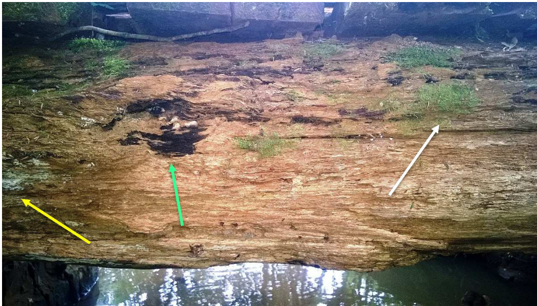
Fotografia 11 – Presença de manchas, hifas de fungos e musgo na viga A Fonte: O autor (2015).
