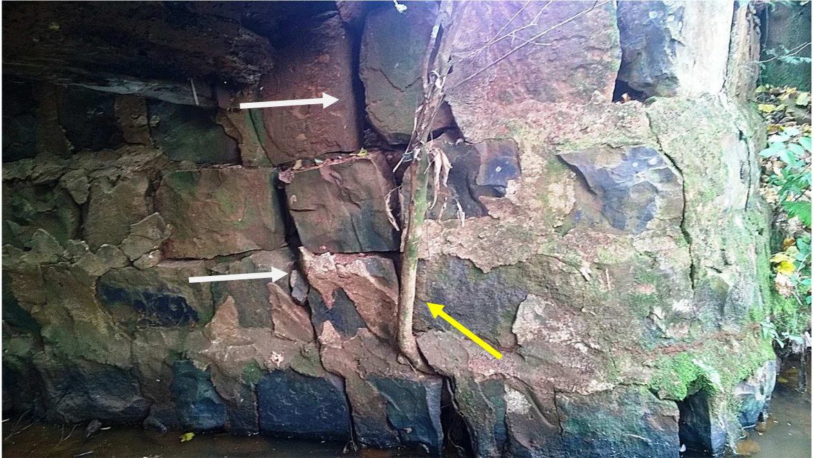
Fotografia 20 – Trincas, desprendimento de argamassa e crescimento de planta (Lado Norte) Fonte: O autor (2015).
