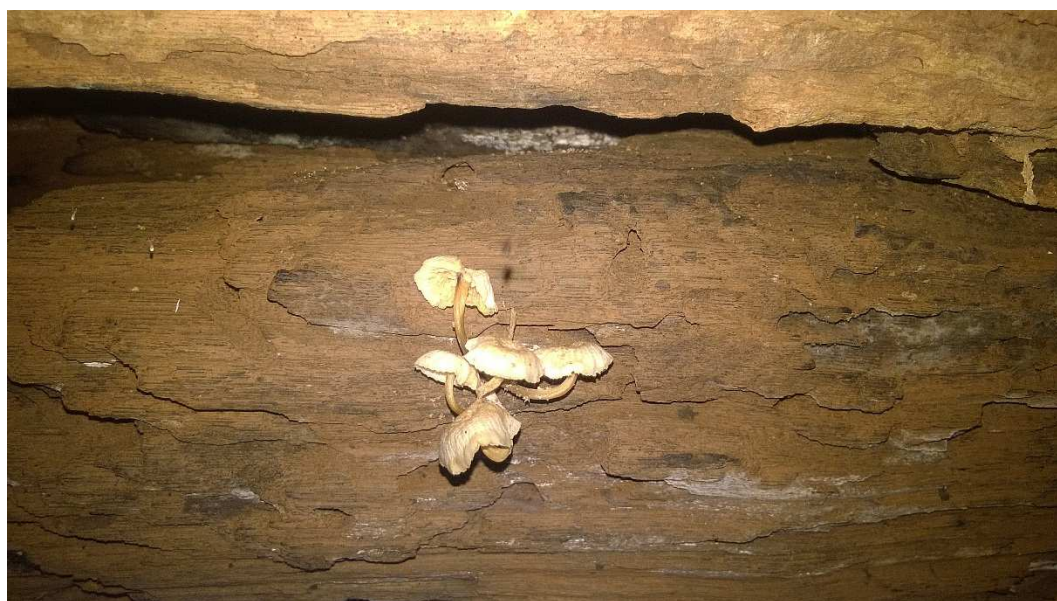
Fotografia 12 – Presença de cogumelos na viga A Fonte: O autor (2015).
