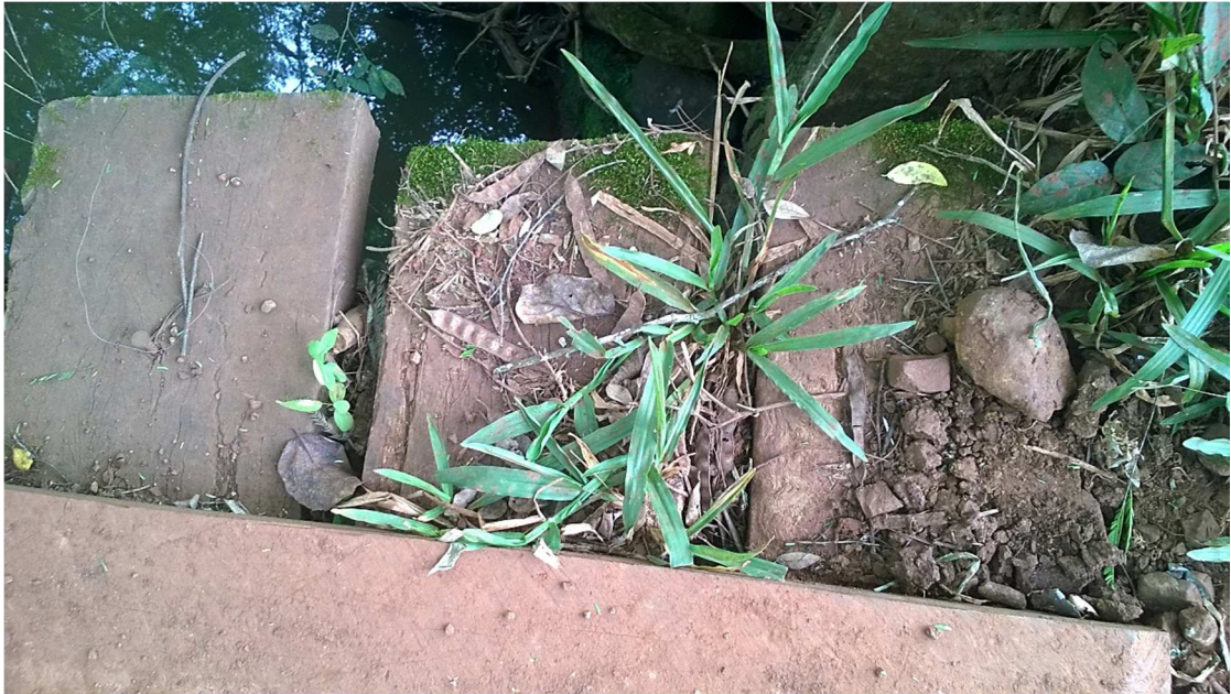
Fotografia 9 – Acúmulo de solo e crescimento de vegetação no tabuleiro Fonte: O autor (2015).
