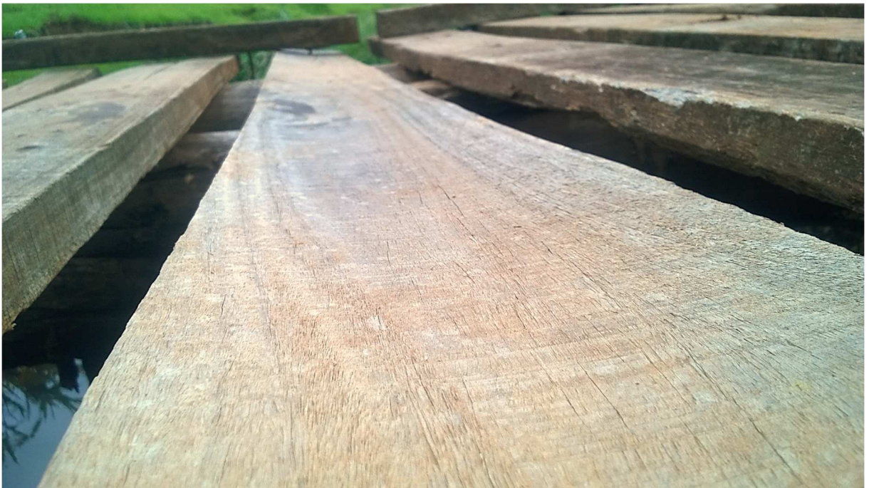
Fotografia 32 – Encanoamento em prancha do tabuleiro devido à secagem in loco Fonte: O autor (2015).
