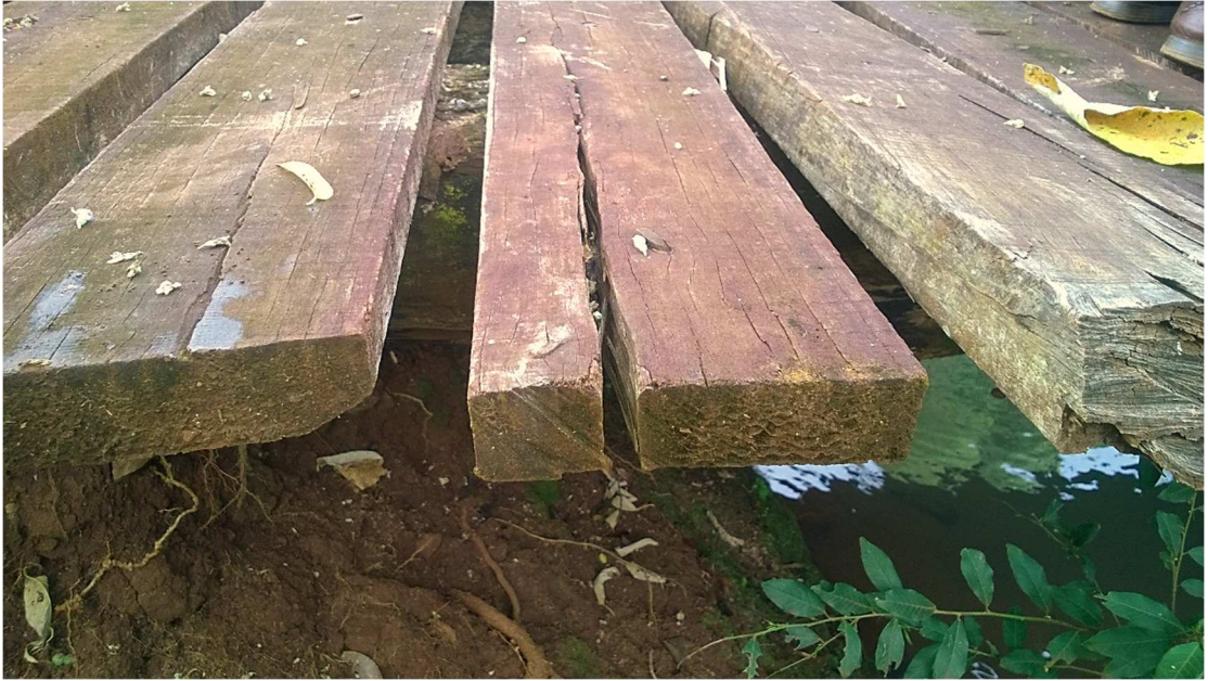
Fotografia 29 – Pranchas rachadas nas extremidades devido à secagem in loco Fonte: O autor (2015).
