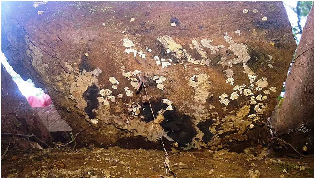
Fotografia 7 – Presença de hifas de fungos causadores deterioração Fonte: O autor (2015).
