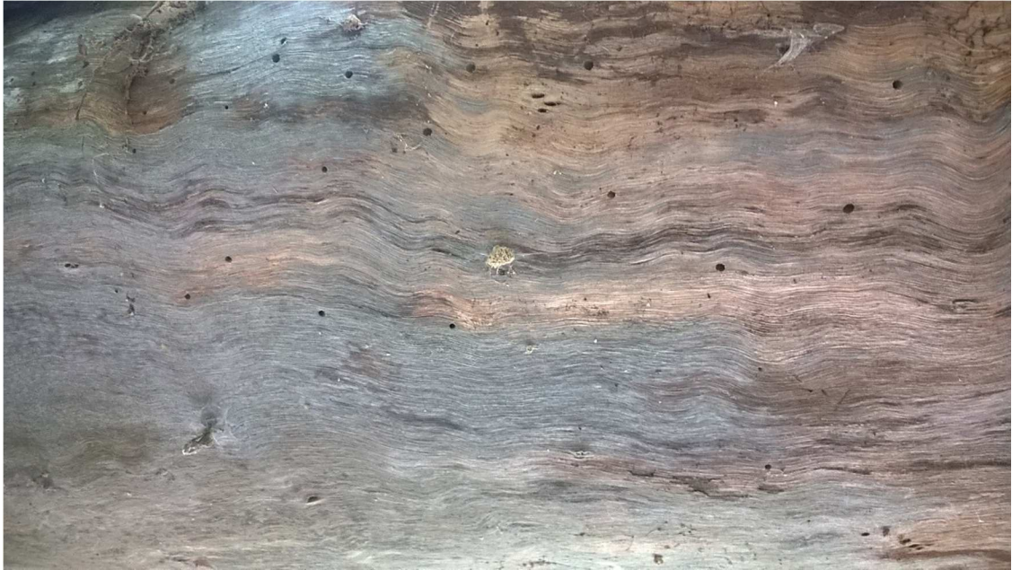
Fotografia 25 – Pequenas perfurações de insetos na Viga D (Ponte 3) Fonte: O autor (2015).
