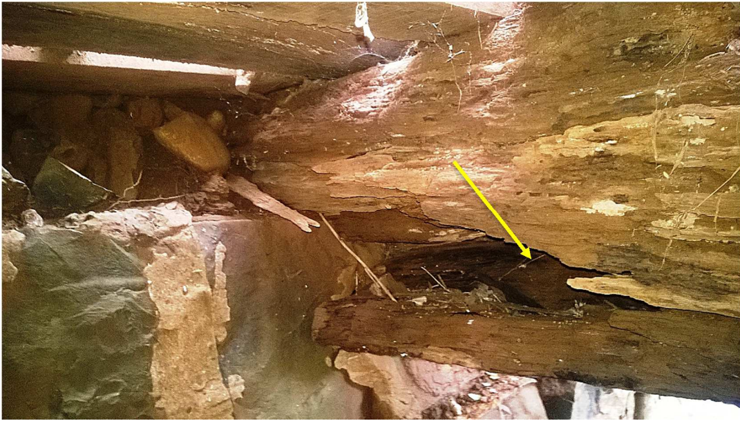
Fotografia 17 – Rachadura estrutural séria, ruptura por fendilhamento (Viga C - Lado norte) Fonte: O autor (2015).
