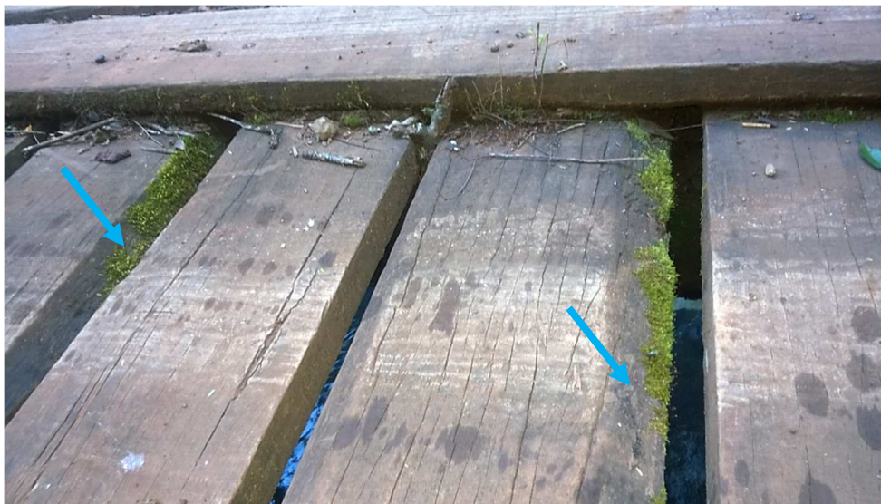
Fotografia 22 – Pranchas do tabuleiro com arestas quebradas Fonte: O autor (2015).
