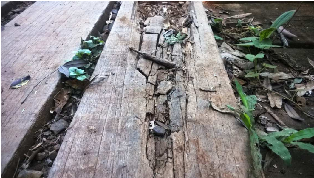
Fotografia 24 – Apodrecimento de prancha do rodeiro após danos por abrasão Fonte: O autor (2015).
