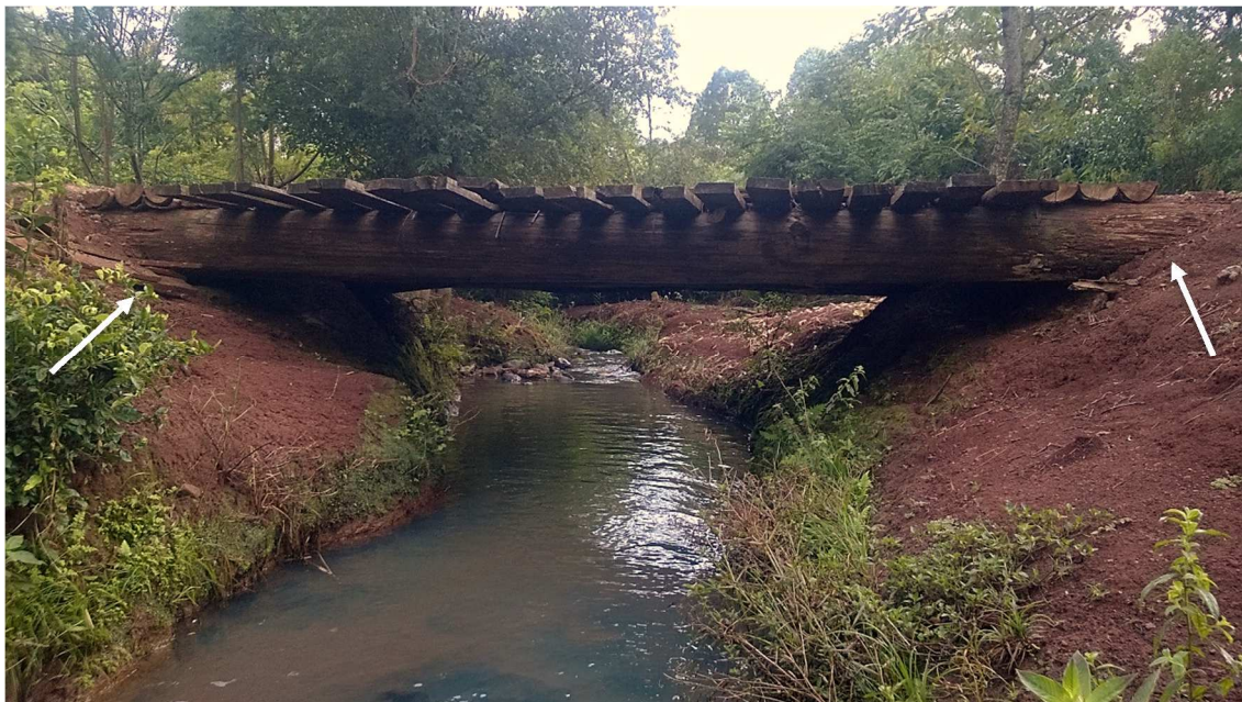
Fotografia 28 – Vigas apoiadas diretamente sobre o solo Fonte: O autor (2015).
