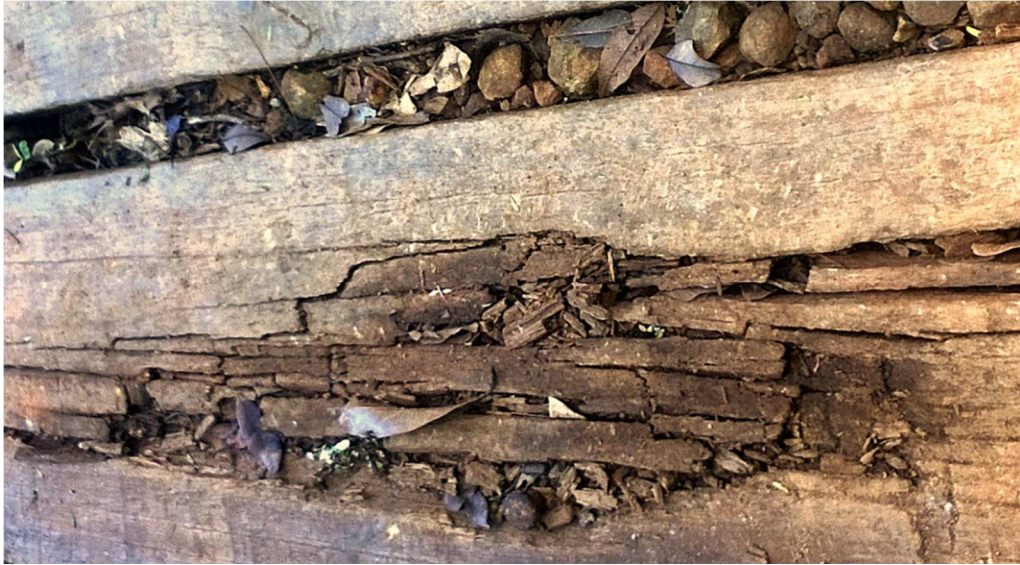
Figura 18 – Peça de madeira danificada por abrasão mecânica Fonte: O autor (2015).
