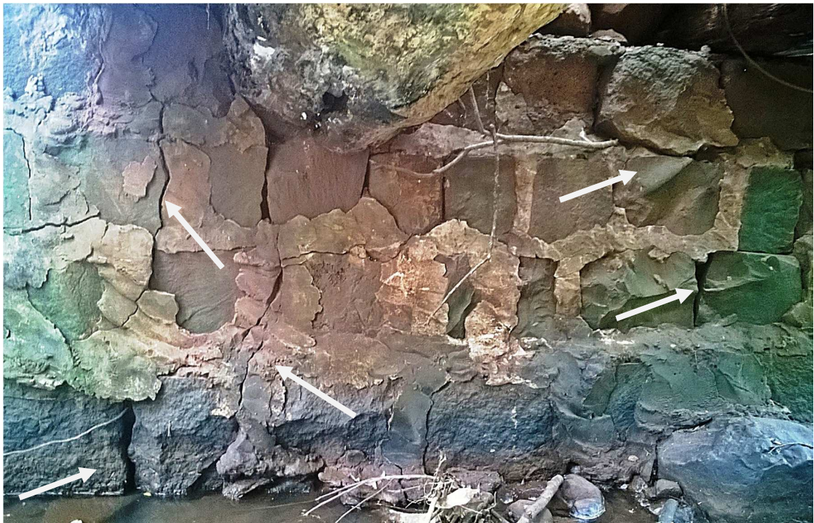
Fotografia 19 – Trincas no muro por sobrecargas e desprendimento de argamassa (Lado Sul) Fonte: O autor (2015).
