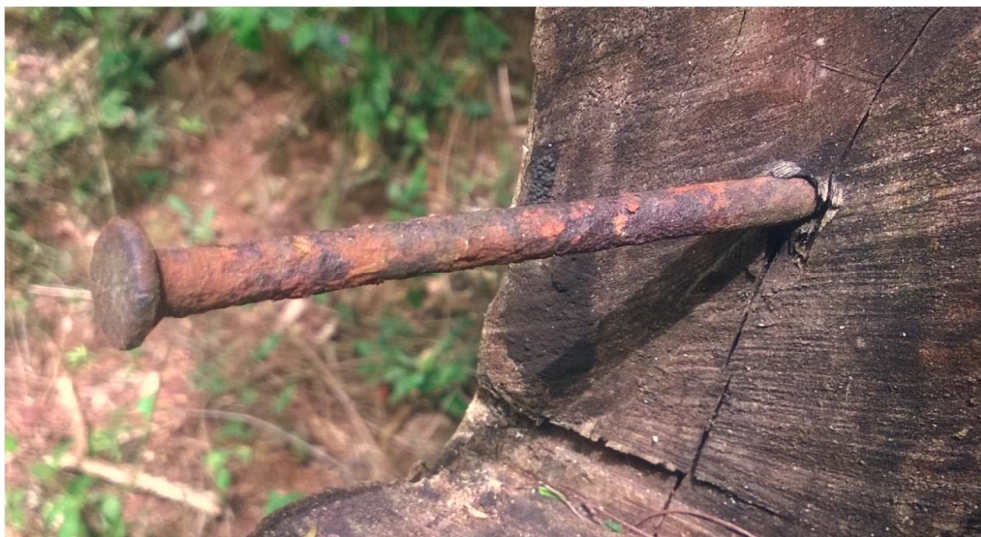
Figura 21 – Aspecto de prego sofrendo corrosão Fonte: O autor (2015).
