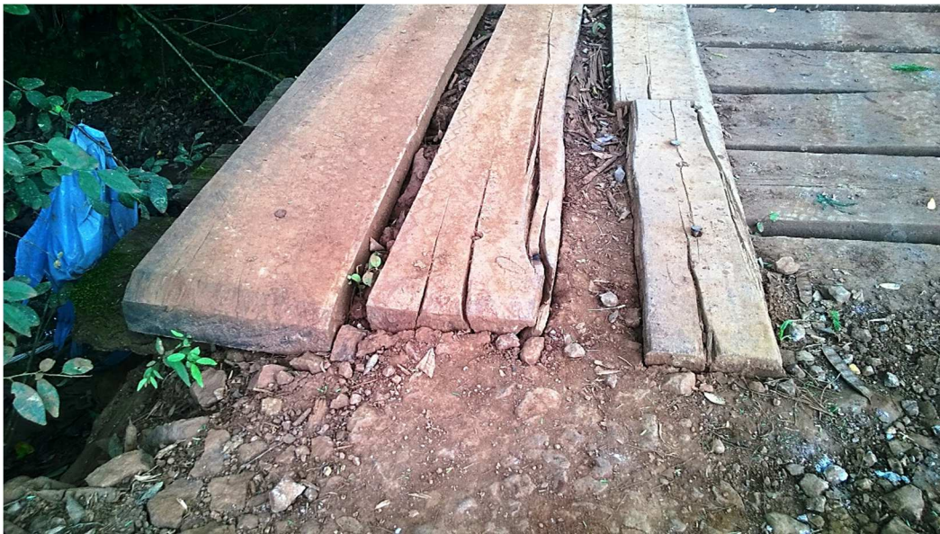
Fotografia 4 – Acúmulo de solo entre as pranchas do rodeiro Fonte: O autor (2015).
