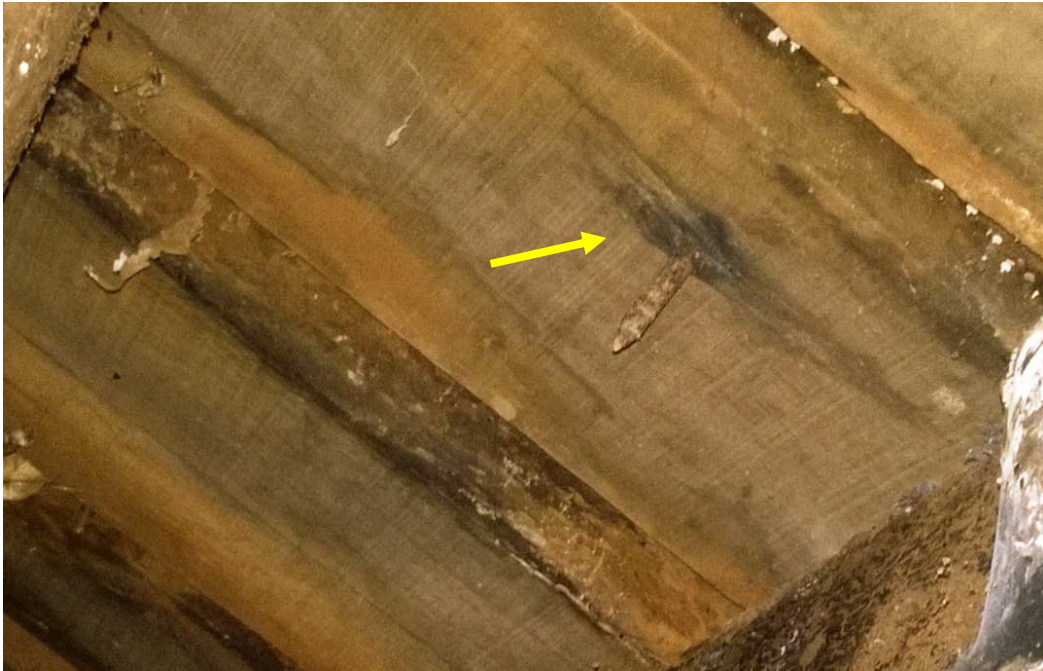
Fotografia 23 – Mancha escura decorrente da deterioração do prego de aço Fonte: O autor (2015).
