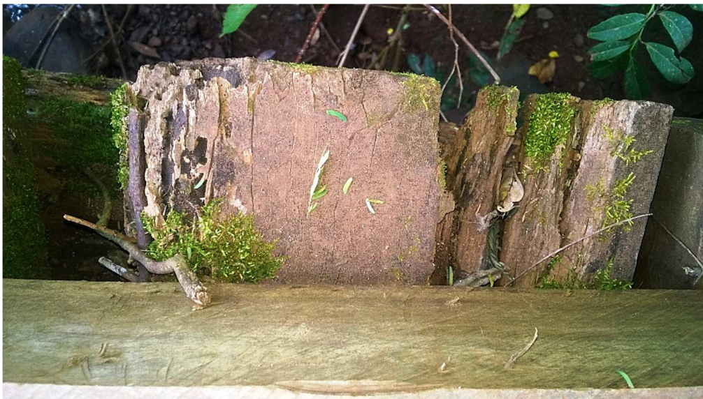
Fotografia 8 – Pranchas com extremidades rachadas e degradação Fonte: O autor (2015).
