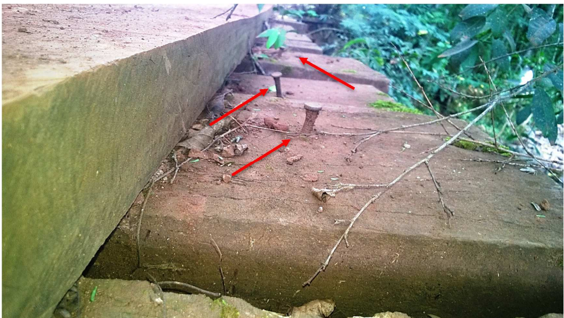
Fotografia 10 – Afrouxamento dos pregos de aço do tabuleiro Fonte: O autor (2015).
