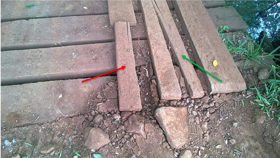
Fotografia 5 – Rachaduras nas pranchas do rodeiro Fonte: O autor (2015).
