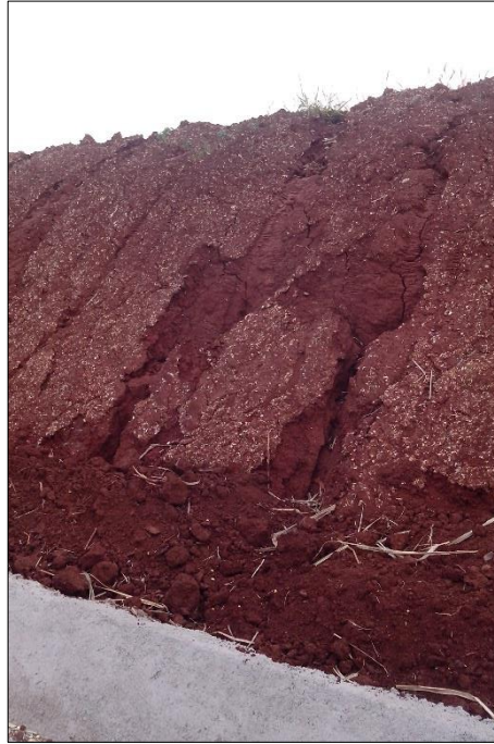
Figura 18: Erosão em sulcos no talude de corte Fonte: Elaboração própria
