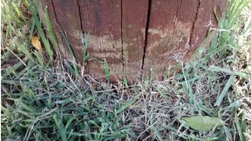
Figura 15: Poste de iluminação em contato com o solo. Fonte: O Autor
