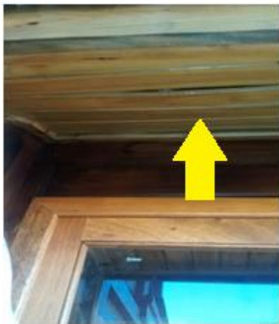
Figura 25: Falha do telhado. Fonte: O Autor
