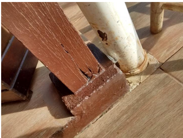
Figura 52: Detalhe da base de um pilarete, com indícios de deterioração. Fonte: O Autor
