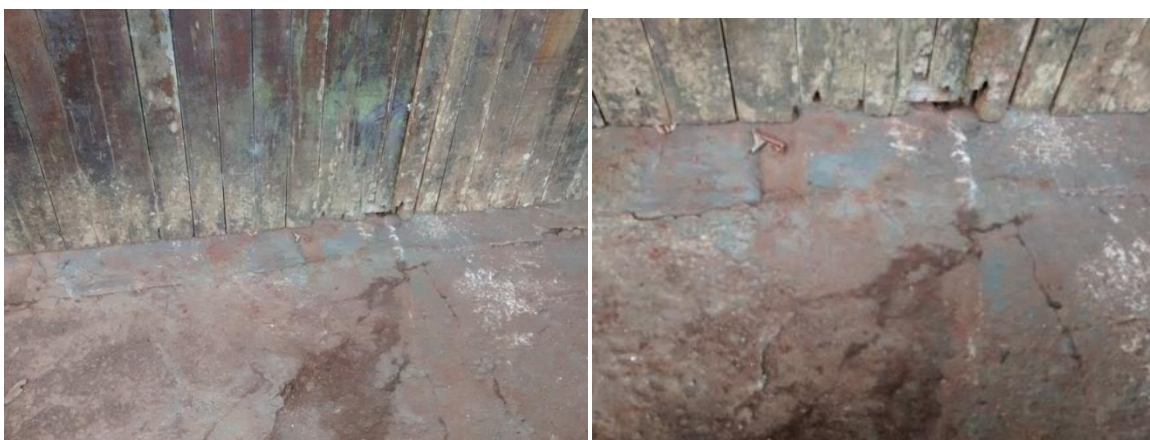
Figura 55: Ação da biodeterioração em portão de madeira. Fonte: O Autor
