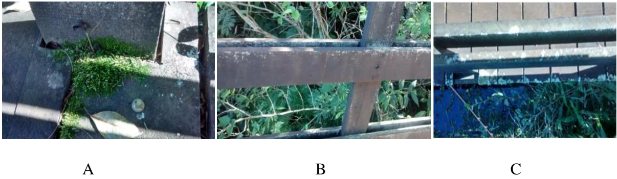
Figura 31: Detalhes de ataques biológicos em uma ponte de madeira. Fonte: O Autor
