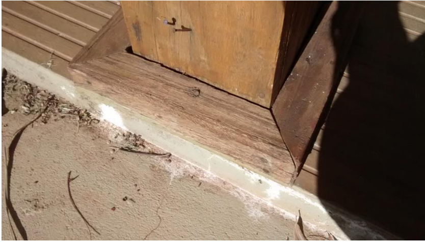
Figura 19: Detalhe dos pequenos vãos entre as peças de madeira. Fonte O Autor
