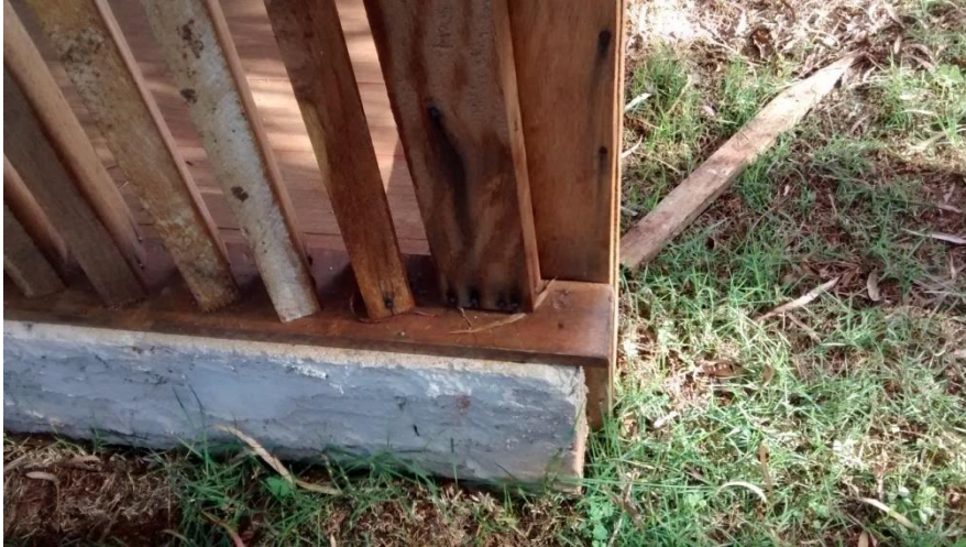
Figura 21: Peças de madeira com manchas nas regiões que há pregos. Fonte: O Autor
