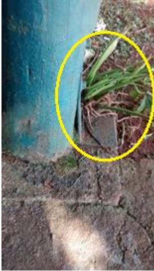
Figura 28: Detalhe da proliferação de fungos em pilar de madeira. Fonte: O Autor
