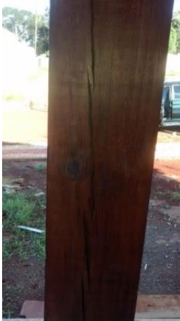
Figura 23: Pilar com rachaduras longitudinais. Fonte: O Autor
