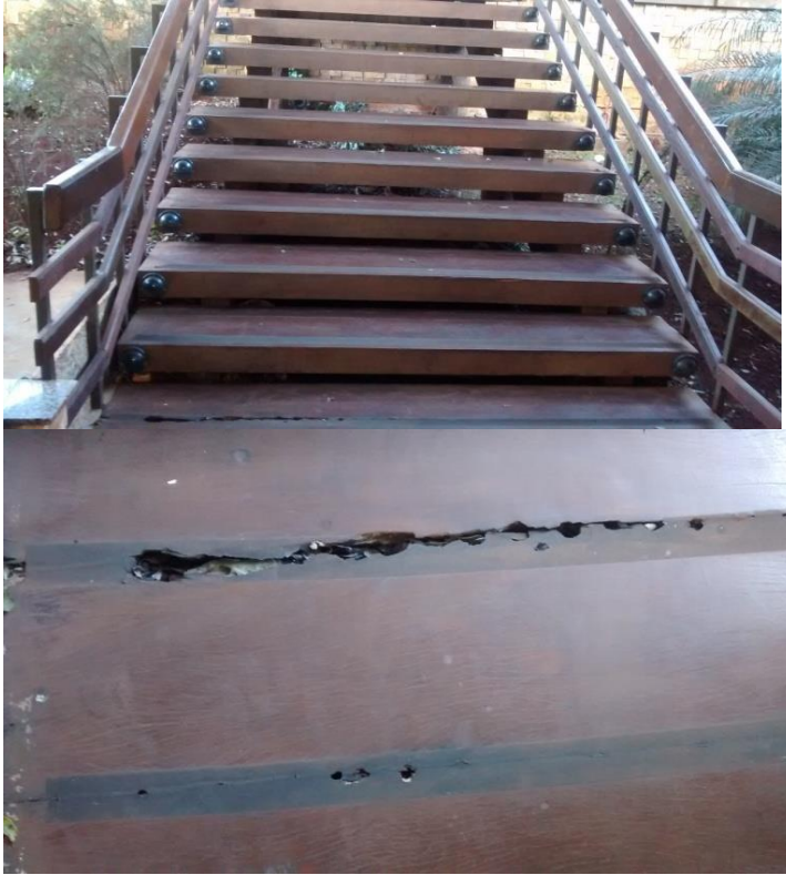
Figura 42: Escada em madeira com detalhe da deterioração. Fonte: O Autor
