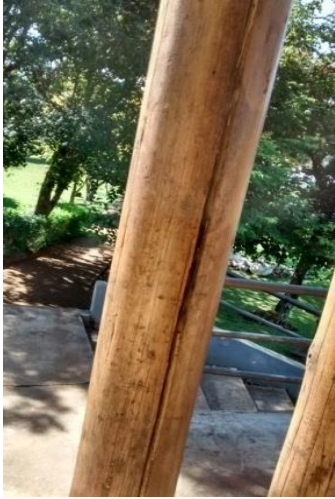
Figura 36: Rachadura em pilar. Fonte: O Autor
