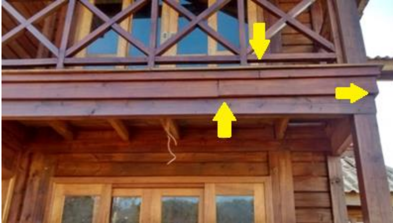
Figura 22: Falhas de emendas. Fonte: O Autor
