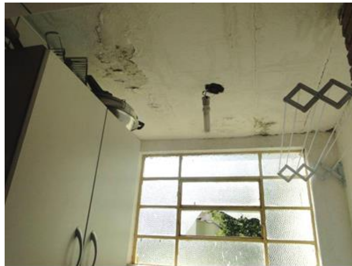
Figura 17 D: Vista de laje com infiltração e vidro quebrado em janela do depósito. Fonte: Autoria própria, 2015.
