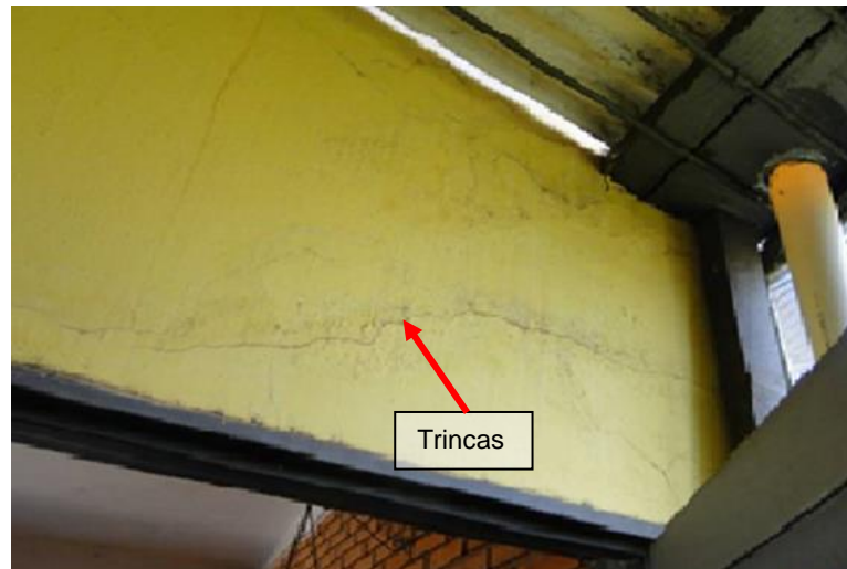
Figura 3 C: Vista de trinca do muro de divisa, em frente a área de serviço. Fonte: Aatoria própria, 2015.
