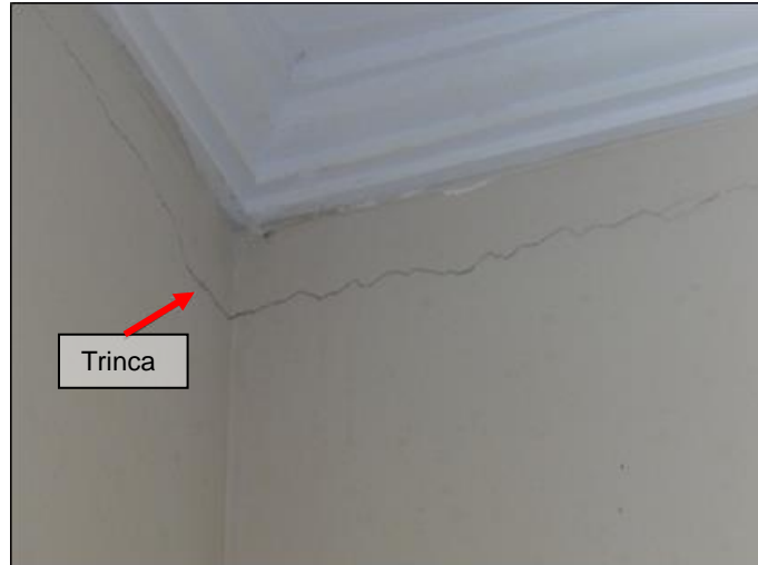
Figura 40 - Vista de trincas horizontais entre a parede e o teto do quarto 1. Fonte: Autoria própria, 2015.
