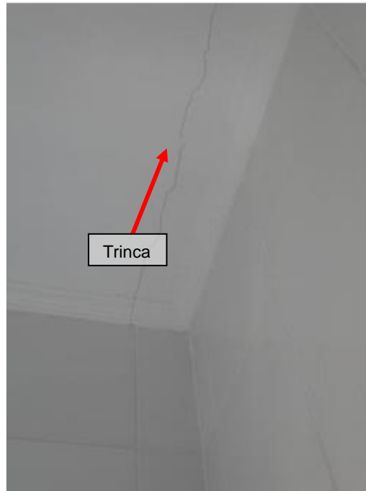
Figura 23 - Vista da trinca em destaque na laje do banheiro. Fonte: Autorial própria, 2015.
