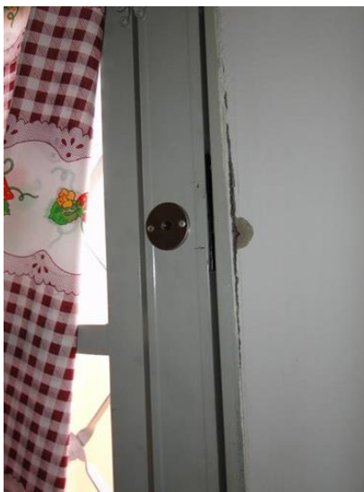
Figura 2 G: Vista em detalhe de fechadura de segurança da porta da cozinha com parede danificada. Fonte: Autoria própria, 2015.
