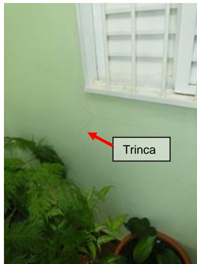
Figura 4 D: Vista da janela com trinca. Fonte: Autoria própria, 2015.
