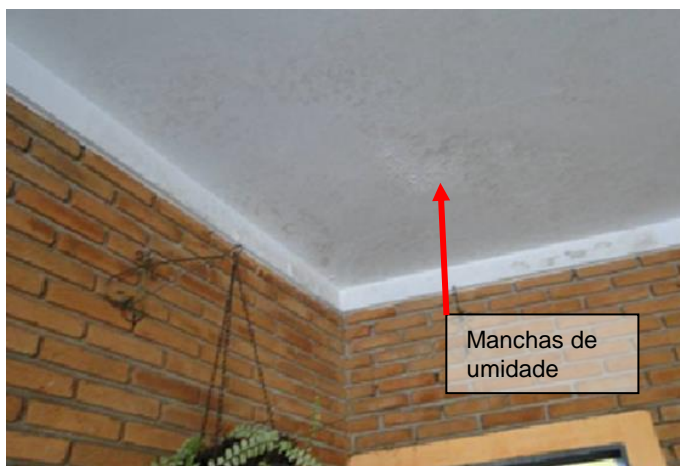
Figura 26 - Vista geral do teto da garagem com umidade. Fonte: Autoria própria, 2015.
