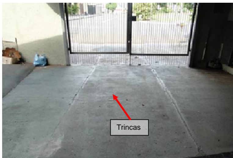
Figura 1 C: Vista em primeiro plano do piso da garagem com pequenas trincas. Fonte: Autoria própria, 2015.
