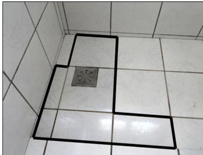
Figura 41 - Vista de piso cerâmico mais escuro no banheiro devido à umidade. Fonte: Autoria própria, 2015.
