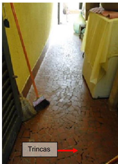
Figura 5 C: Vista de trincas de piso no acesso à área de serviço. Fonte: Aatoria própria, 2015.
