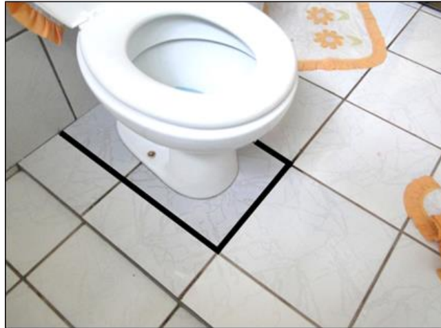
Figura 1 F: Vista de piso cerâmico mais escuro no banheiro devido à umidade. Fonte: Aatoria própria, 2015.
