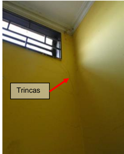
Figura 14 C: Vista de trinca próxima ao vidro da cozinha. Fonte: Autoria própria, 2015.
