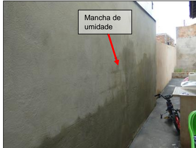
Figura 6 F: Vista de manchas de umidade no muro de divisa. Fonte: Autoria própria, 2015.
