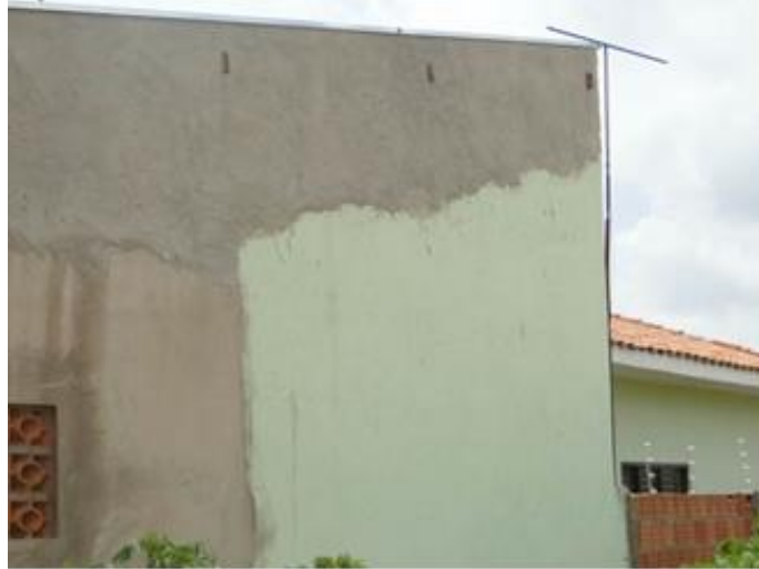
Figura 1 B: Parede lateral com sinal de acréscimo. Fonte: Autoria própria, 2015.
