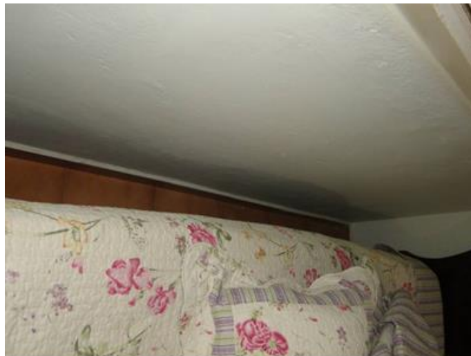
Figura 8 D: Vista do teto do quarto 2 com manchas de umidade. Fonte: Autoria própria, 2015.
