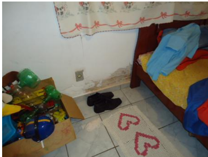
Figura 36 - Vista do quarto 1 com má conservação da pintura. Fonte: Autoria própria, 2015.
