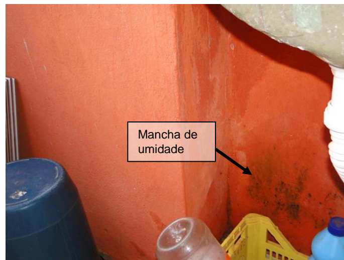
Figura 44 - Vista de mancha de umidade na área de serviço. Fonte: Autoria própria, 2015.
