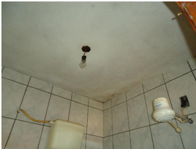
Figura 1 E: Vista do banheiro da área de serviço com umidade. Fonte: Autoria própria, 2015.
