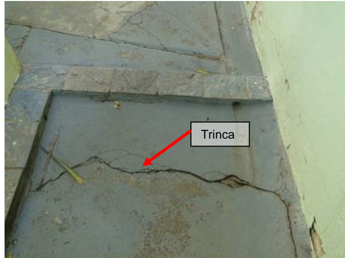
Figura 14 D: Vista de trinca em piso do corredor. Fonte: Autoria própria, 2015.
