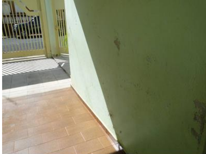
Figura 5 D: Vista da parede da garagem com infiltração e umidade. Fonte: Autoria própria, 2015.
