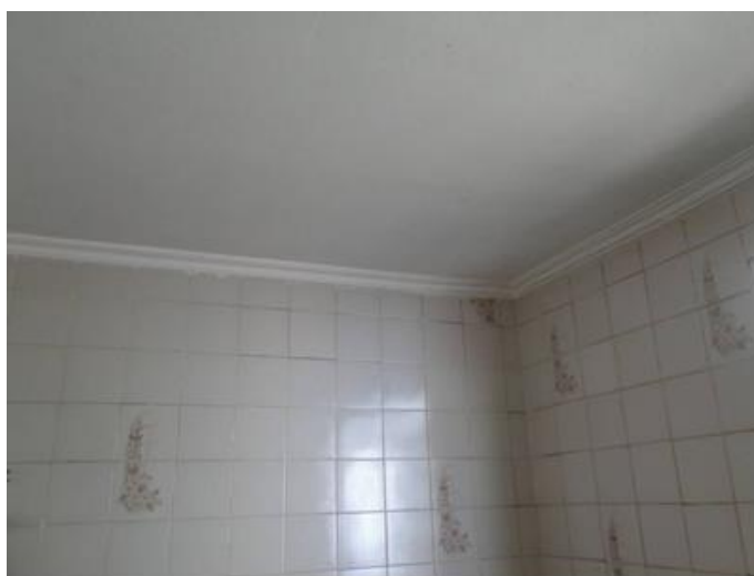
Figura 2 D: Vista da cozinha com revestimentos sem rejunte. Fonte: Autoria própria, 2015.
