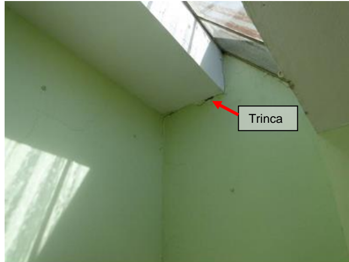
Figura 3 D: Vista da parede dos fundos. Fonte: Autoria própria, 2015.
