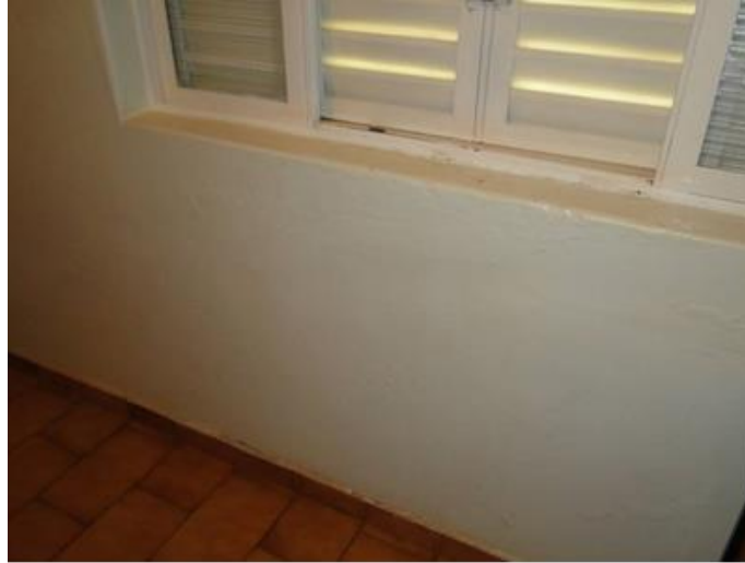
Figura 7 D: Vista da janela do quarto 1 com manchas de umidade. Fonte: Autoria própria, 2015.
