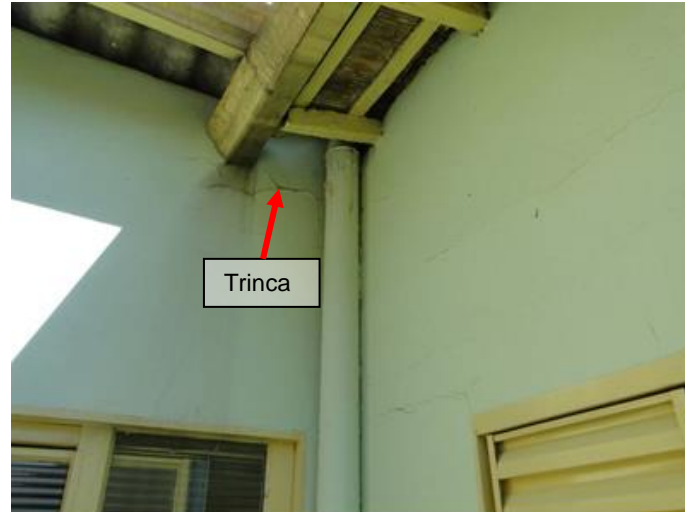
Figura 16 D: Vista de trinca próximo ao beiral. Fonte: Autoria própria, 2015.
