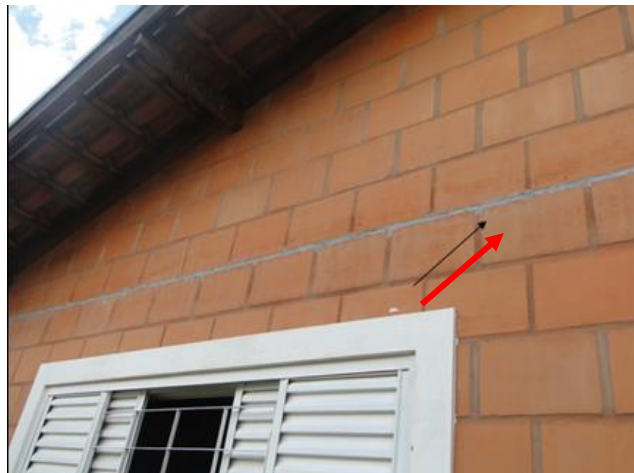
Figura 4 F: Vista de junta de dilatação executada pelo proprietário. Fonte: Autoria própria, 2015.
