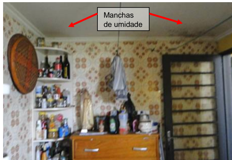
Figura 4 C: Vista de manchas de umidade na cozinha. Fonte: Aatoria própria, 2015.
