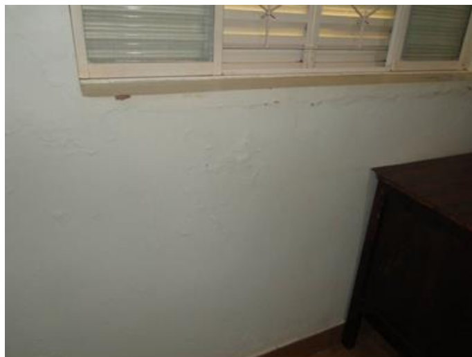
Figura 10 D: Vista da janela do quarto 3 com manchas de umidade. Fonte: Autoria própria, 2015.
