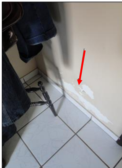
Figura 2 F: Vista de desprendimento de tinta do quarto 2. Fonte: Aatoria própria, 2015.
