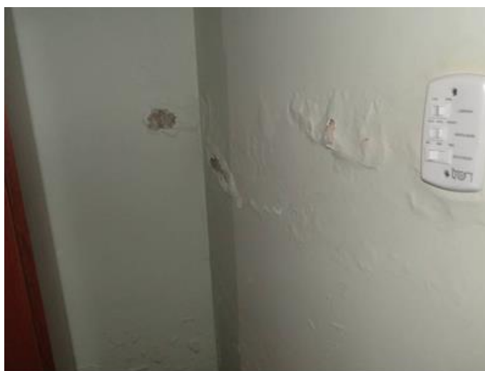
Figura 33 - Vista em detalhe da parede do quarto 3 com umidade próximo ao interruptor. Fonte: Autoria própria, 2015.
