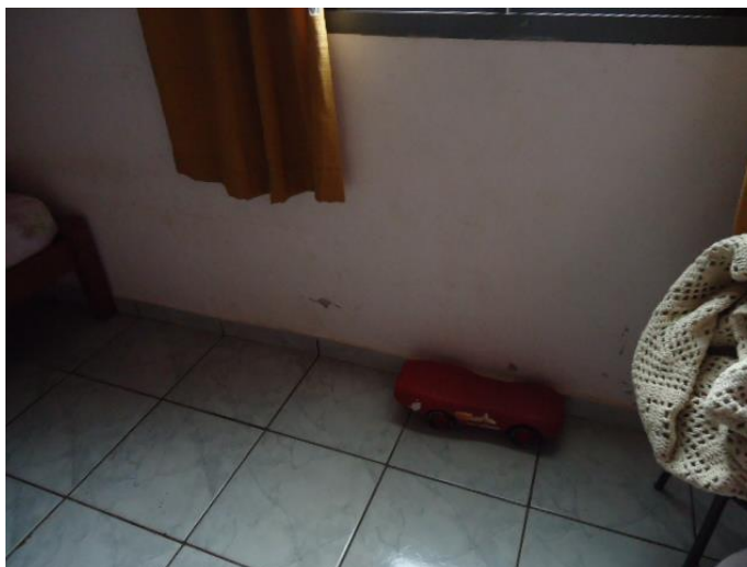
Figura 37 - Vista do quarto 2 com má conservação da pintura. Fonte: Autoria própria, 2015.
