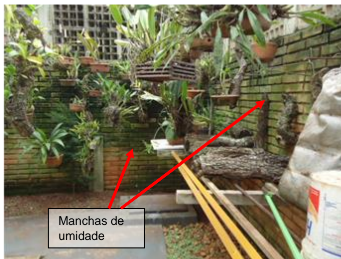
Figura 15 - Vista da parede que faz divisa com o vizinho – Fundo Imóvel Fonte: Autoria própria, 2015.
