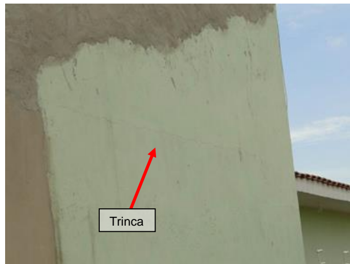
Figura 6 B: Vista em destaque da trinca na parede lateral externa. Fonte: Autoria própria, 2015.
