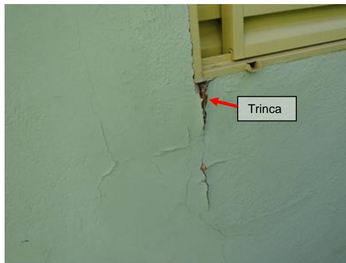
Figura 13 D: Vista de trinca em janela. Fonte: Autoria própria, 2015.
