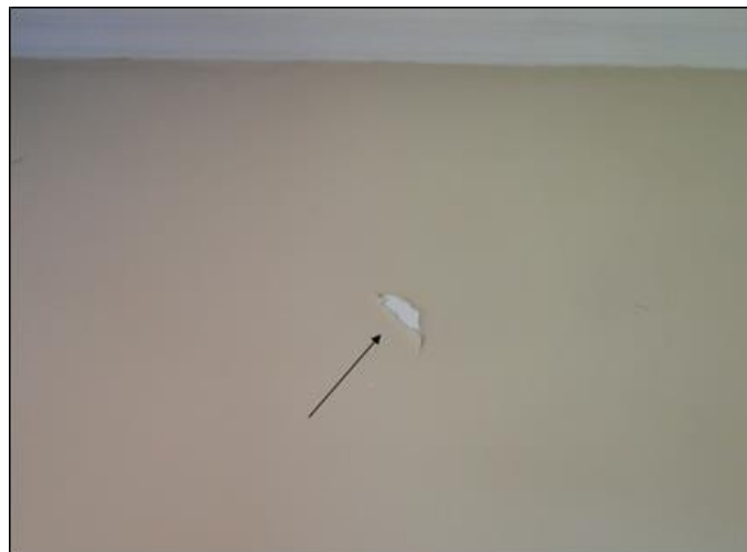
Figura 7 F: Vista de desprendimento da pintura na sala. Fonte: Autoria própria, 2015.
