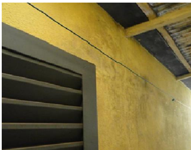
Figura 7 C: Vista trincas e manchas de umidade próximo ao caixilho do dormitório 1. Fonte: Aatoria própria, 2015.
