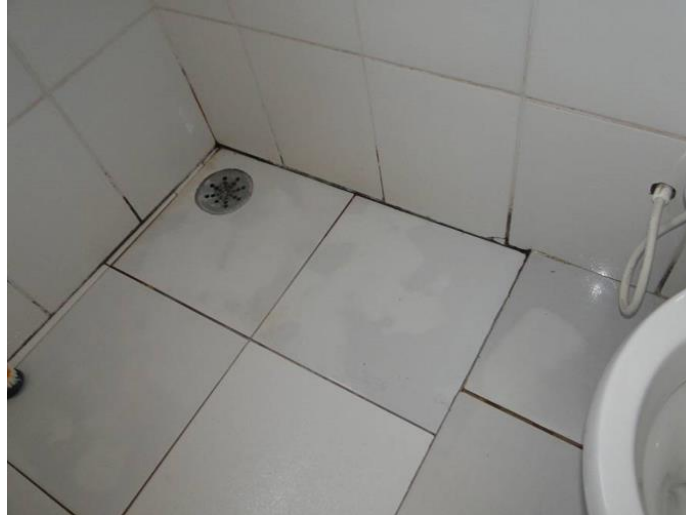
Figura 3 G: Vista de umidade no banheiro. Fonte: Autoria própria, 2015.
