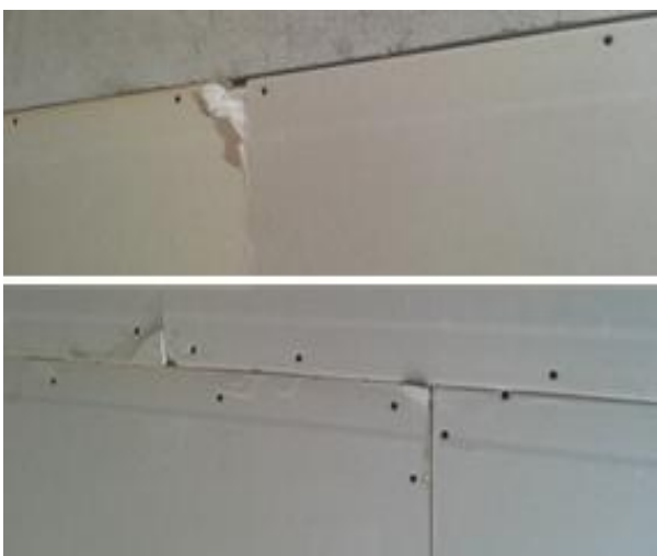
Figura 19 – Vértices das placas de gessos “amassados”.
