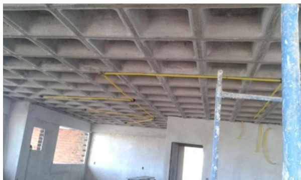
Figura 12– Instalação elétrica no teto
