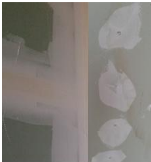
Figura 32 – Tratamento das juntas e parafusos de fixação do gesso acartonado – 1ª camada
