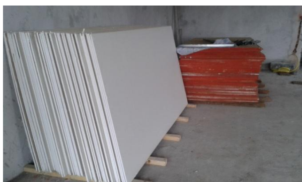
Figura 18 – Componentes estocados no mesmo andar a ser executado, porém no apartamento ao lado do previsto.
