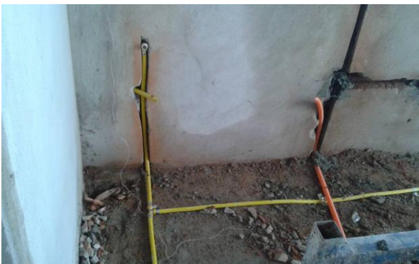
Figura 14 – Instalação de gás encanado na cozinha
