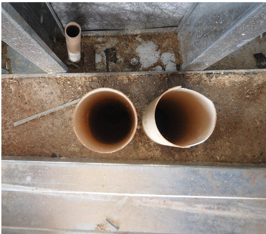
Figura 38 – Instalações hidráulicas. Fonte: Arquivo do Autor.
