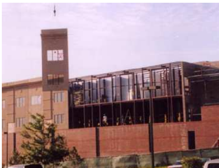
Figura 4 - Montagem de painéis pré-fabricados em Light Steel Framing com acabamento executado previamente. Fonte: AEGIS METAL FRAMING, 2007, apud Santiago, 2008, s/p.
