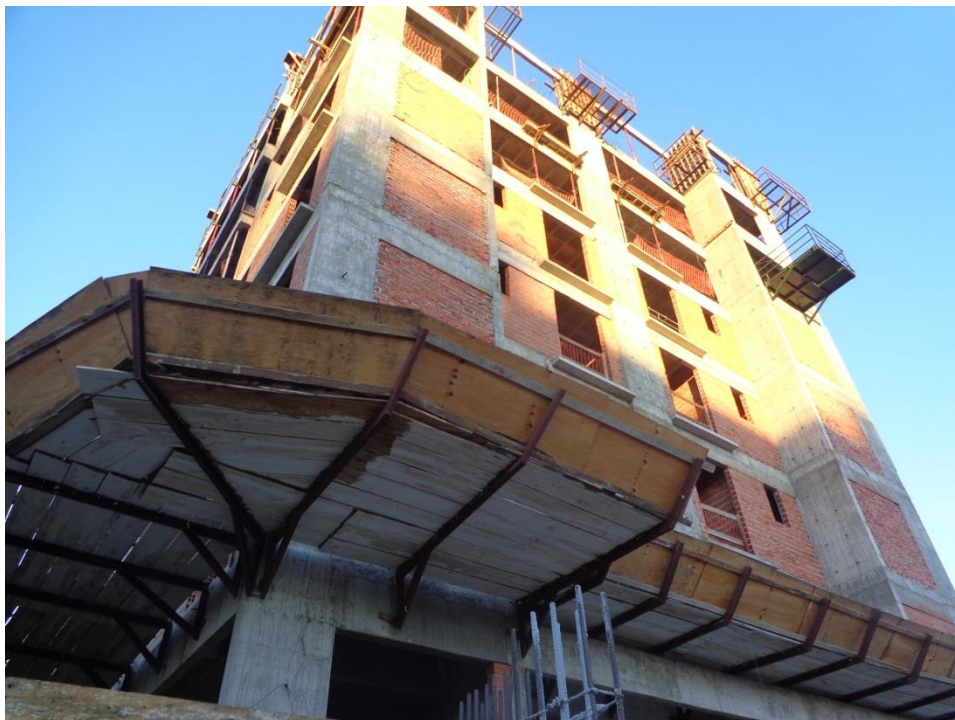
Figura 17 – Dispositivos de proteção para limitação e quedas 1 Obra A
