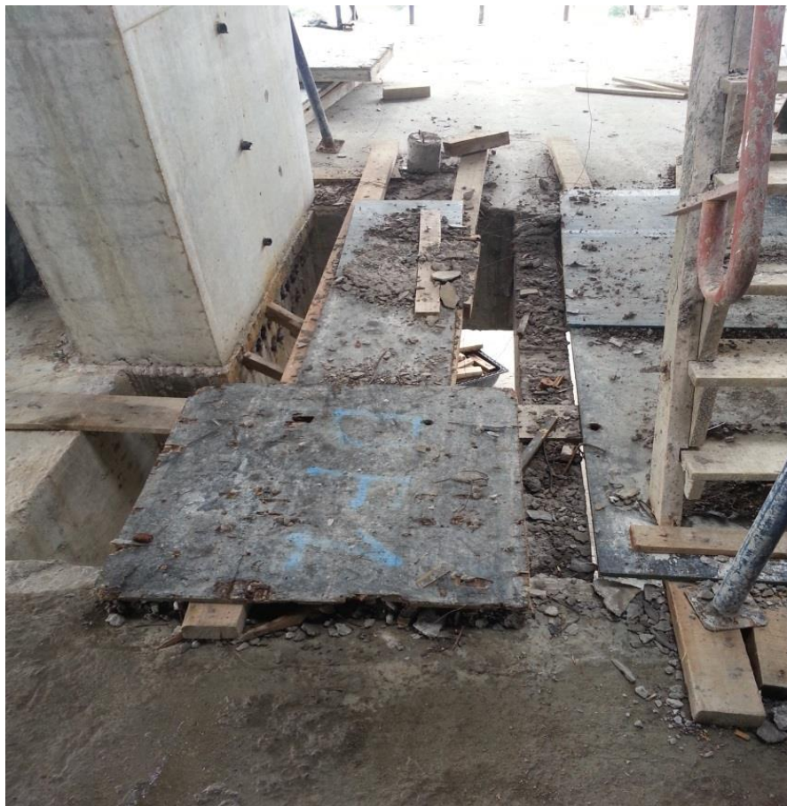
Figura 27– Dispositivos protetores de plano horizontal Obra B Fonte: Arquivo do Autor
