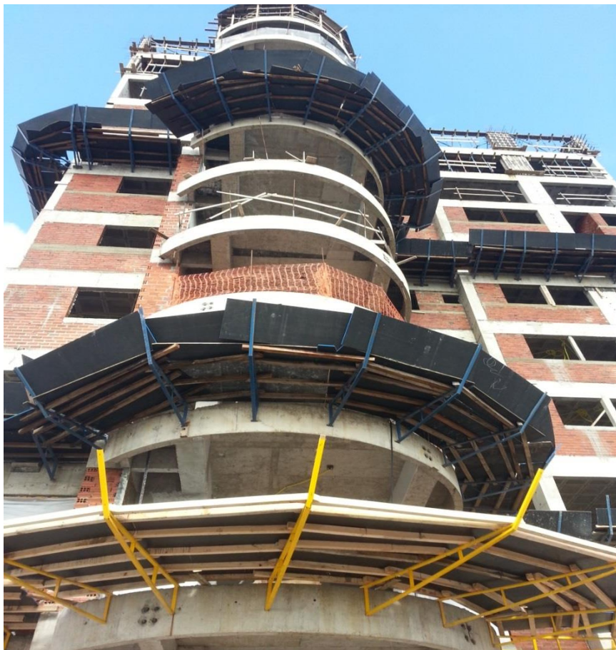
Figura 24– Dispositivos de proteção para limitação e quedas Obra B Fonte: Arquivo do Autor
