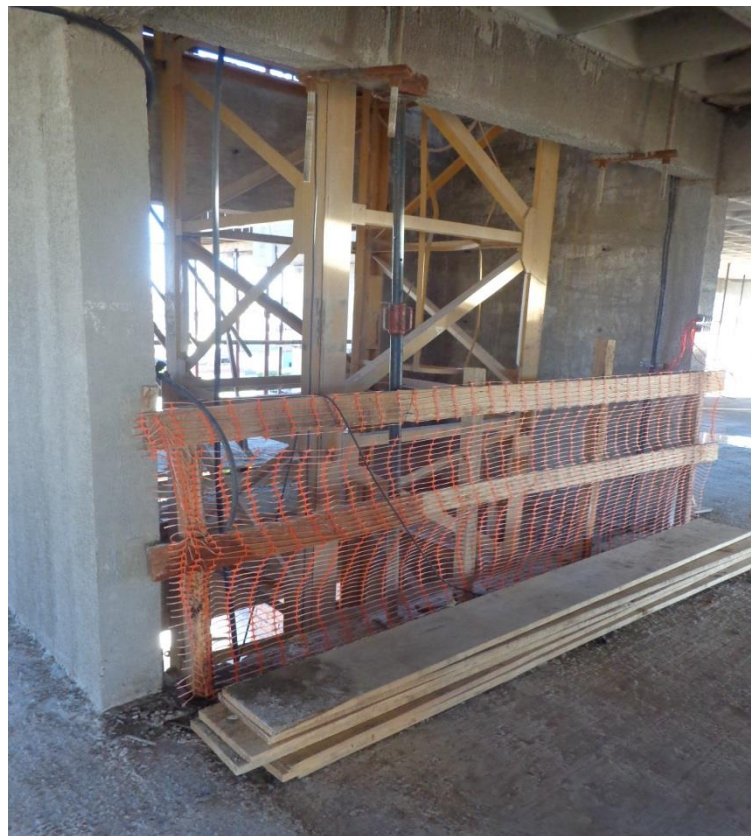
Figura 14 – Sistema de guarda corpo-rodapé Obra A
