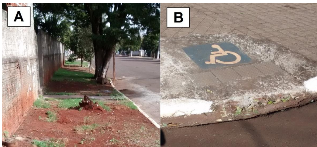
a) Ausência de piso na calçada.
