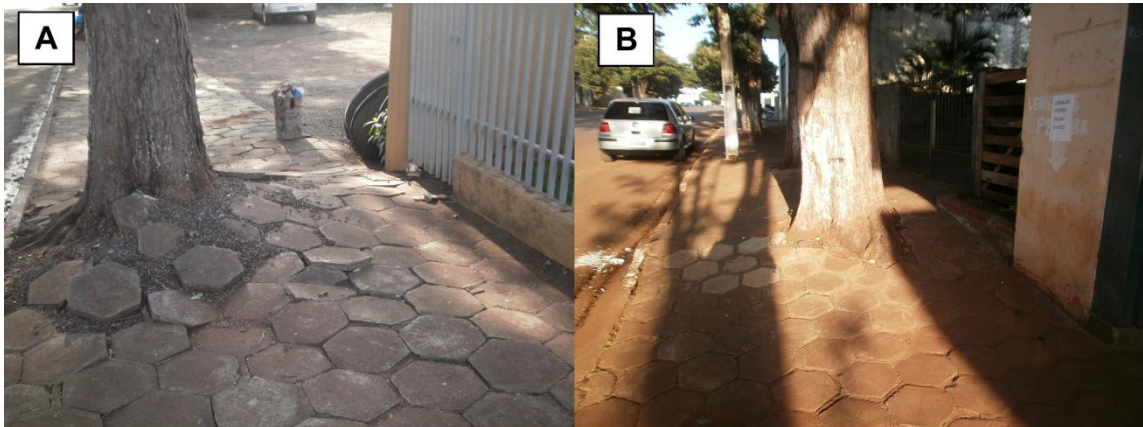
a) Vegetação danificando a calçada.
