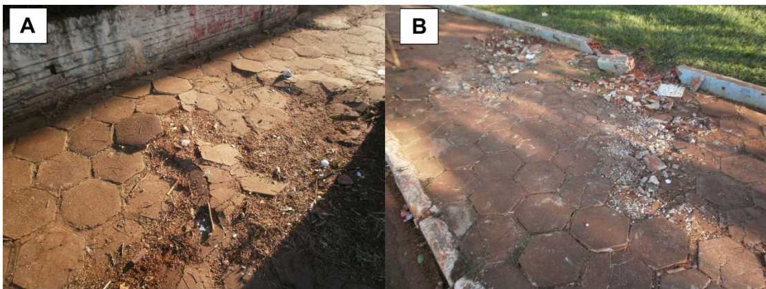
a) Presença de buracos sobre o passeio. b) Calçada mal conservada.
