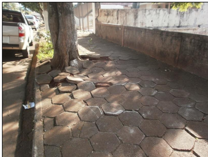
Figura 21 - Calçada danificada pela vegetação Fonte: Dados do Autor (2014).
