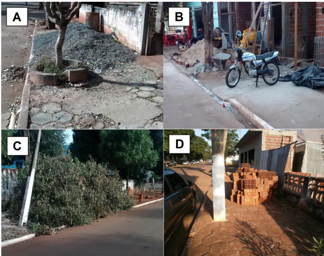
Figura 24 - Entulhos, RCD's e materiais de construção sobre o passeio Fonte: Dados do Autor (2014).
