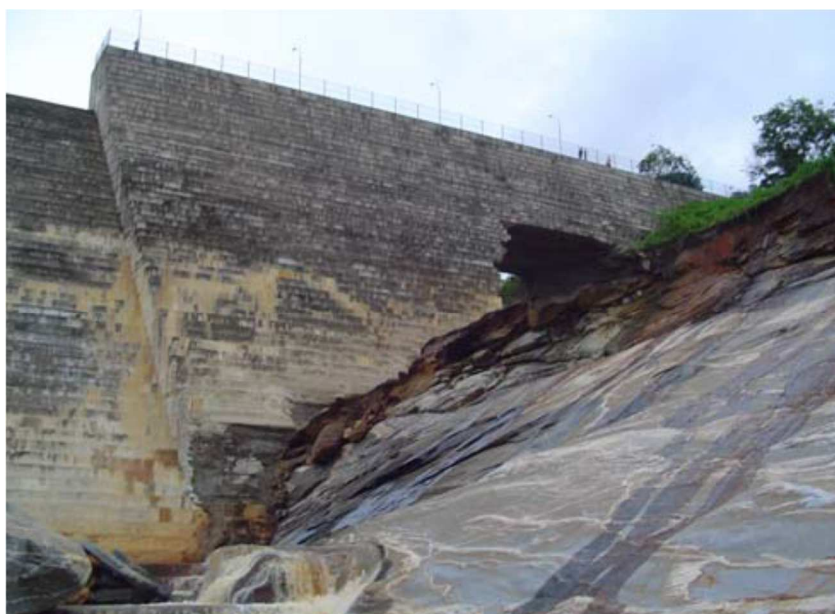
Figura 40 – Brecha gerada pela ruptura na ombreira da barragem Fonte: Barbosa et al. (2004).
