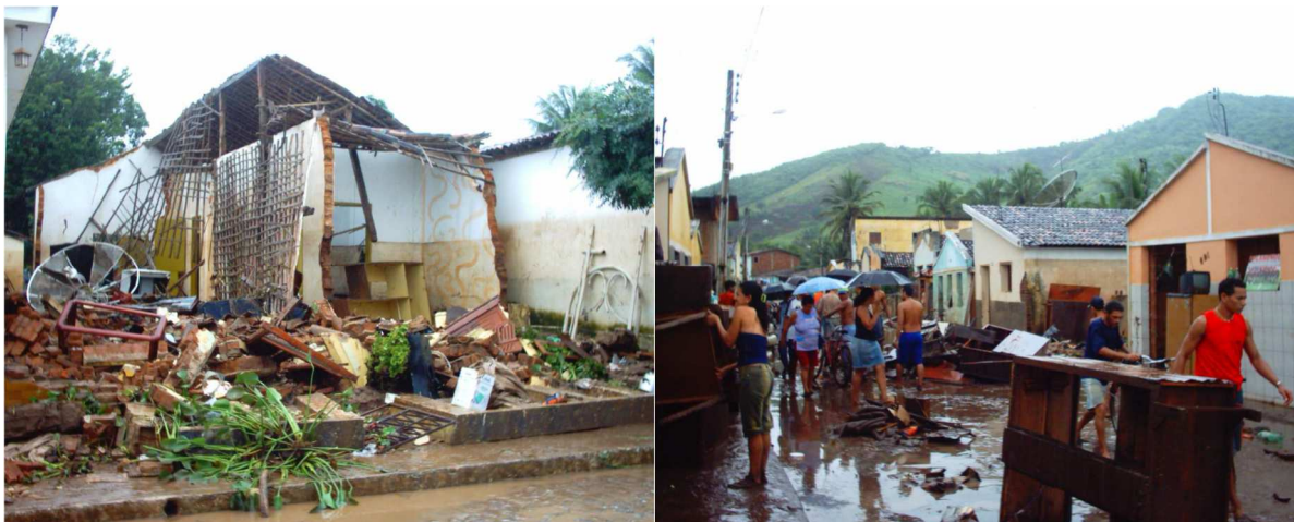
Figura 41 – Casa totalmente destruída seguida de outras danificadas
