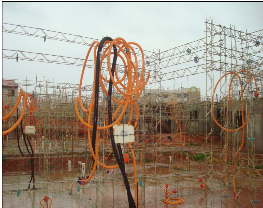
Figura 4 – Eletrodutos e caixas elétricas. Fonte: Elaborado pelo Autor (2013).
