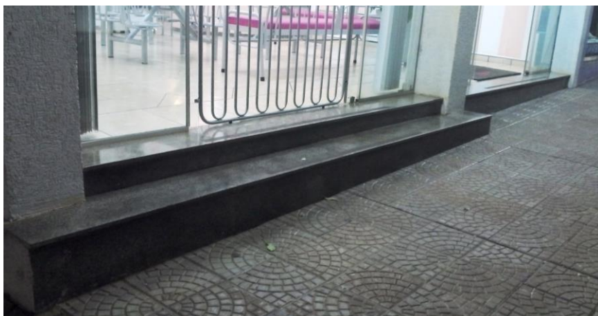
Figura 13 – Desnível de 25 cm Fonte: Autoria própria.
