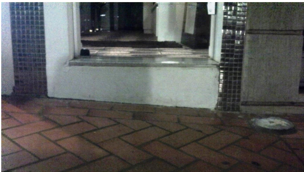
Figura 15 – Desnível de 23 cm Fonte: Autoria própria.
