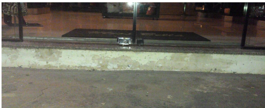
Figura 11 – Desnível de 22 cm Fonte: A autoria própria.
