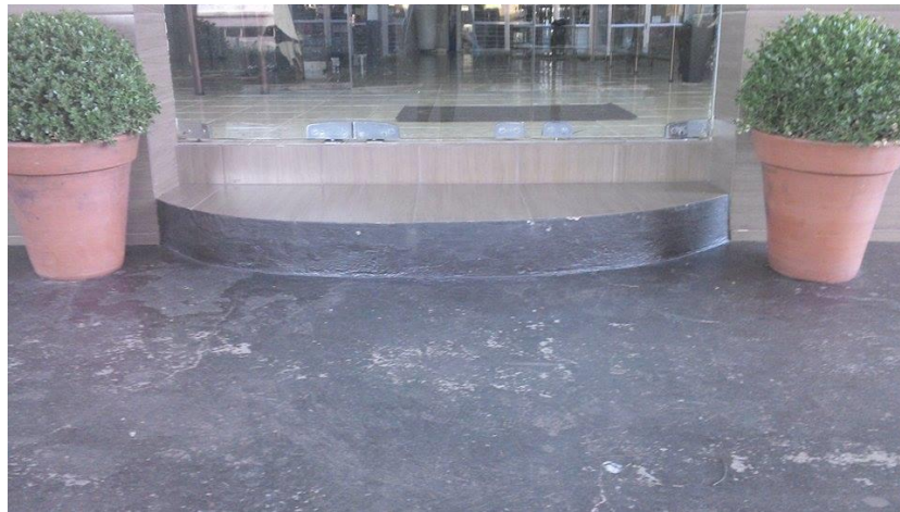
Figura 10 – Desnível de dois degraus Fonte: A autoria própria.
