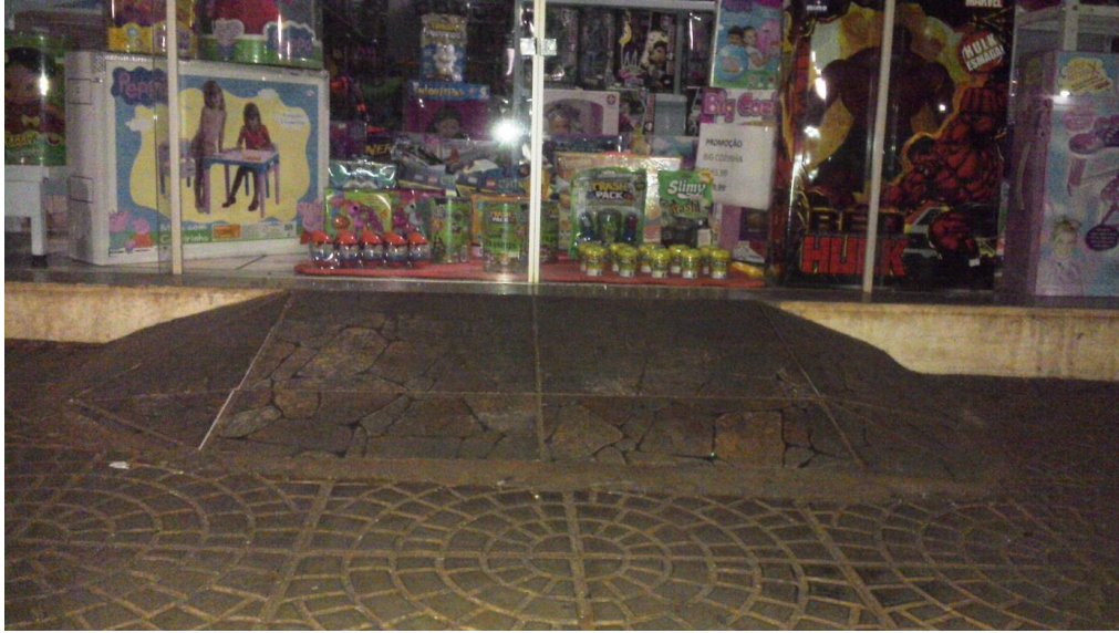
Figura 24 – Rampa inviável Fonte: Autoria própria.
