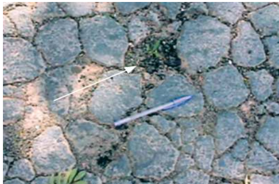
Figura 6 - Trinca tipo couro de jacaré com erosão Fonte: Bernucci et al. (2006)
