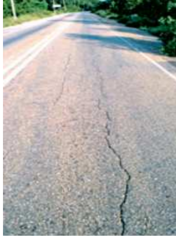
Figura 5 - Trinca longitudinal longa Fonte: Bernucci et al. (2006)
