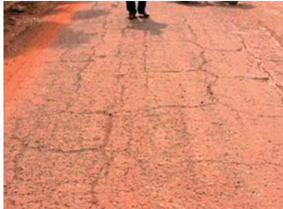
Figura 7 - Trincas tipo bloco com erosão Fonte: Bernucci et al. (2006)
