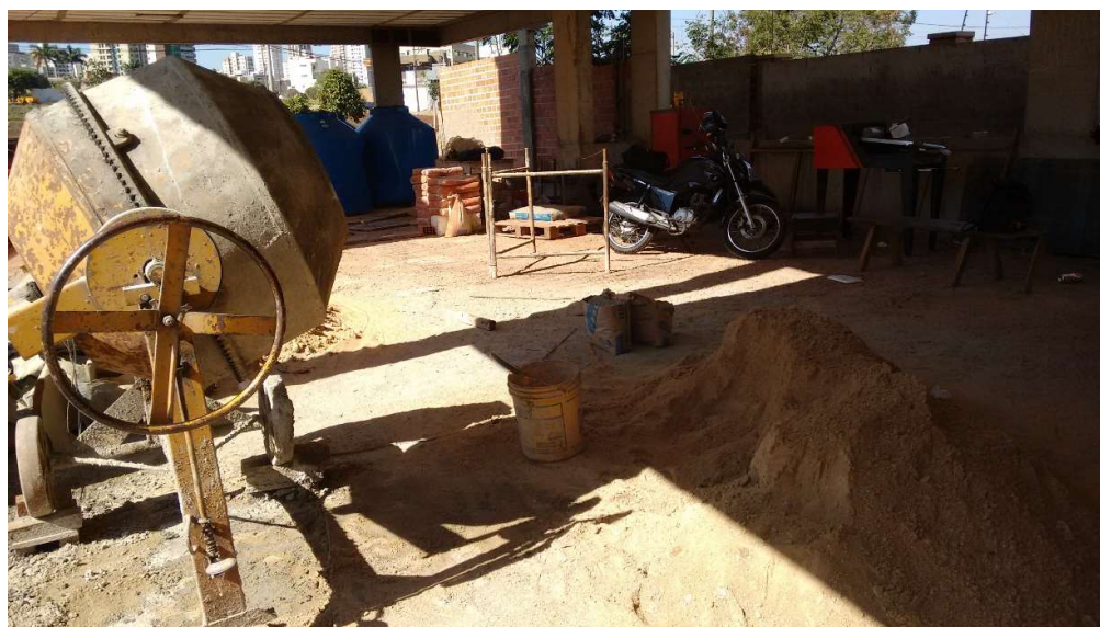
Figura 1 – Areia sem contenção e proteção contra intempéries.
