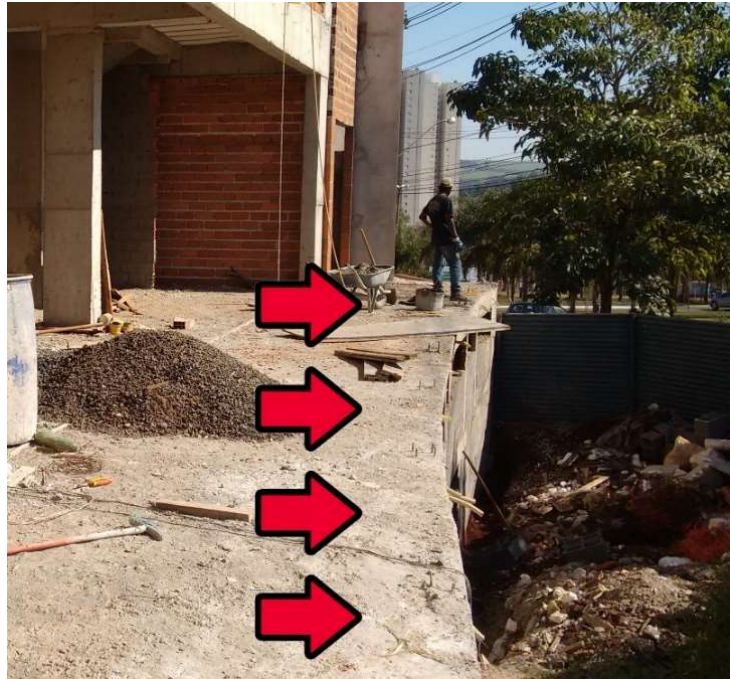
Figura 5 – Desnível encontrado na obra.
