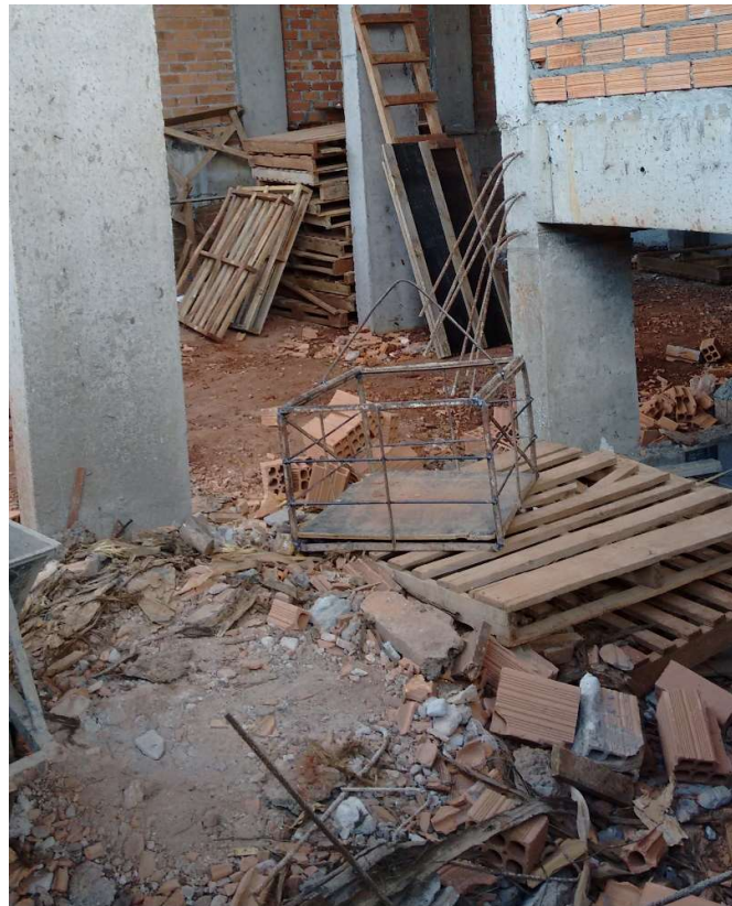
Figura 18 – Entulho encontrado no canteiro da obra C.
