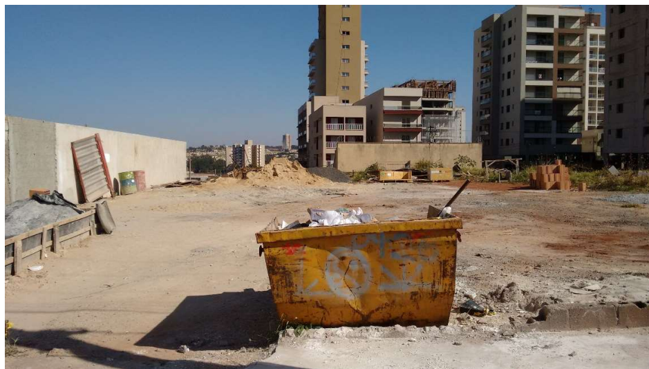
Figura 12 – Caçamba de entulhos, localizada na área de apoio do terreno ao lado.
