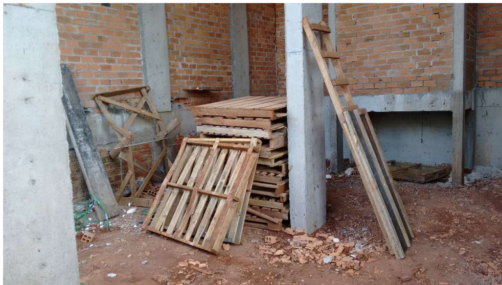
Figura 17 – Espaço mal utilizado para o armazenamento de materiais.
