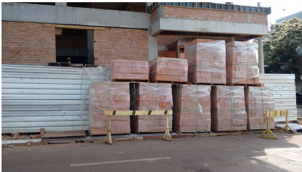
Figura 16 – Pallets de blocos cerâmicos armazenado na calçada. (Obra C)
