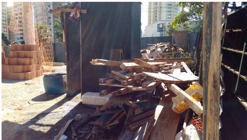
Figura 6 – Entulho armazenado de forma incorreta.
