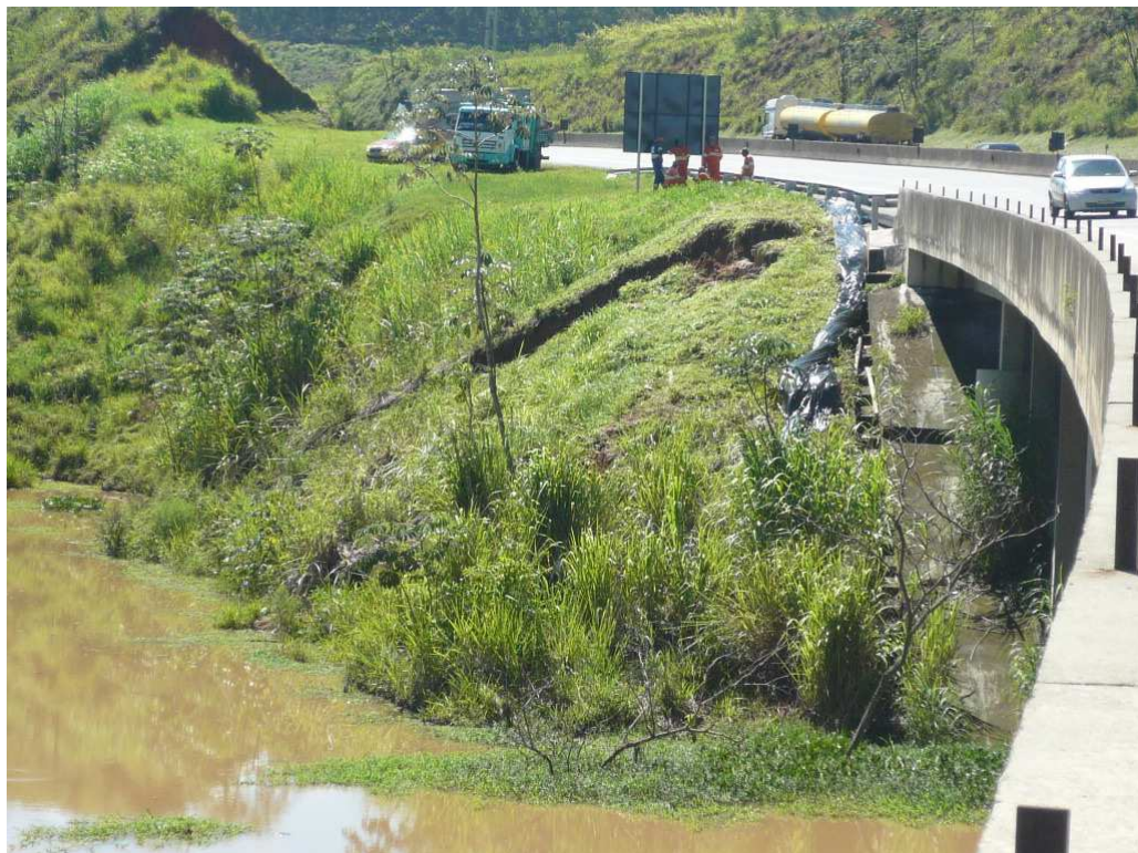
Figura 15: Vista da ruptura, a partir do encontro oposto da ponte Fonte: Confidencial.
