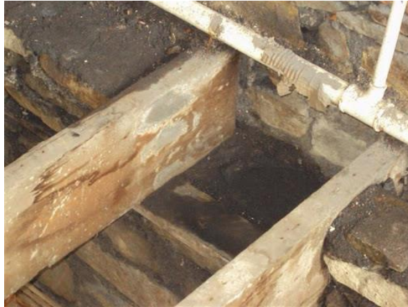
Figura 37 - Madeira prejudicada devido a exposição do acúmulo de água Fonte: Blog Estruturas de Madeira (2015)
