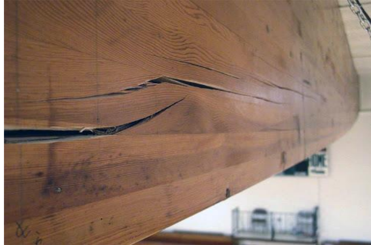
Figura 35 - Fissuras horizontais próxima do apoio Fonte: Blog Estruturas de Madeira (2015)
