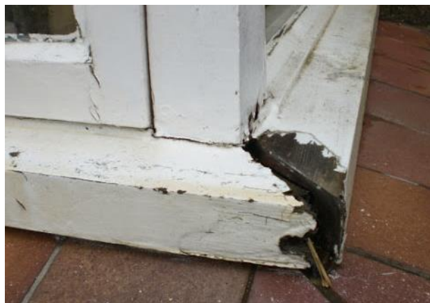
Figura 38 - Rodapé de madeira em contato com o chão Fonte: Blog Estruturas de Madeira (2015)
