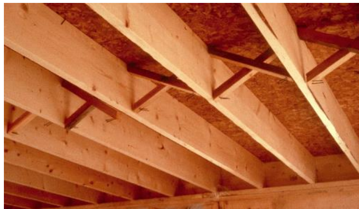
Figura 33 - Vigas contraventadas Fonte: Blog Estruturas de Madeira (2015)
