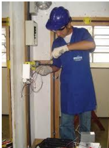
Figura 26 - Instalação residencial Fonte: Senai, (2012).
