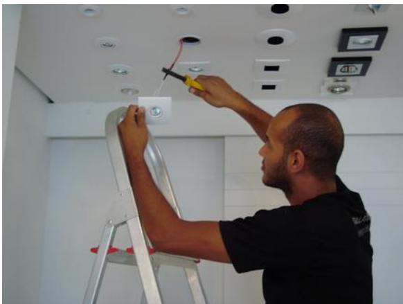
Figura 23 - Instalação elétrica residencial Fonte: JP Instelétrica, (2011).
