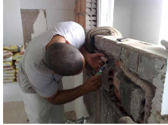
Figura 28 - Instalação hidráulica em paredes Fonte: Carvalho, (2013).
