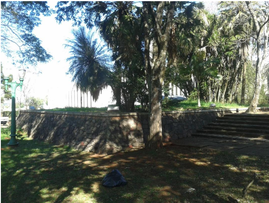
Fotografia 17: Ausência de proteção ou guarda-corpo no canteiro elevado 4. Fonte: Do autor
