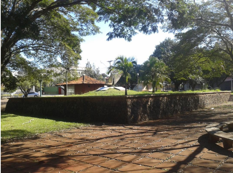
Fotografia 14: Ausência de proteção ou guarda-corpo no canteiro elevado 1. Fonte: Do autor
