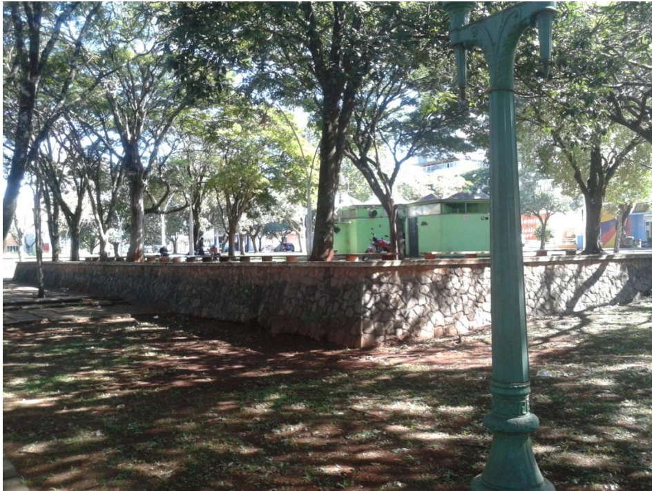
Fotografia 18: Ausência de proteção ou guarda-corpo na elevação em que o calçamento é constituído de placas de concreto.
