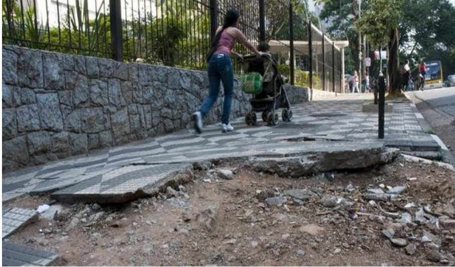
Figura 3 – Pedestre caminha por calçada em mau estado de conservação em avenida de São Paulo Fonte: Mateus Bruxel(2010)
