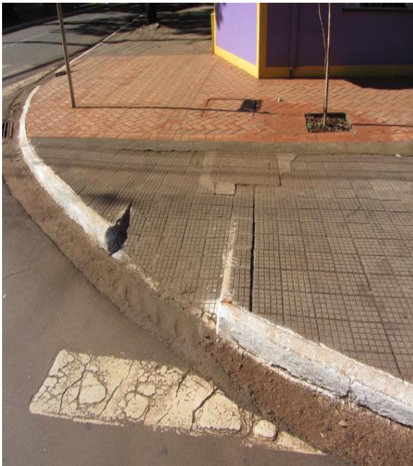
Figura 41- Rampa não conforme Fonte: autor(2014)
