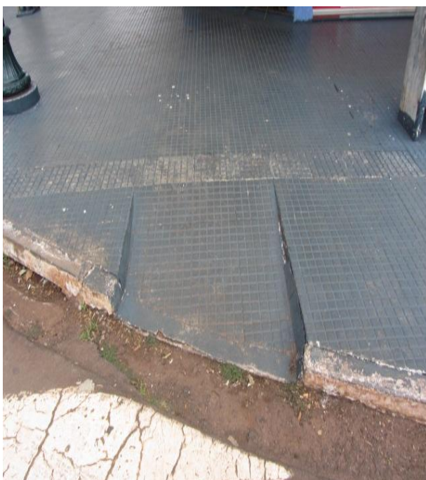
Figura 35- Rampa não conforme Fonte: autor(2014)
