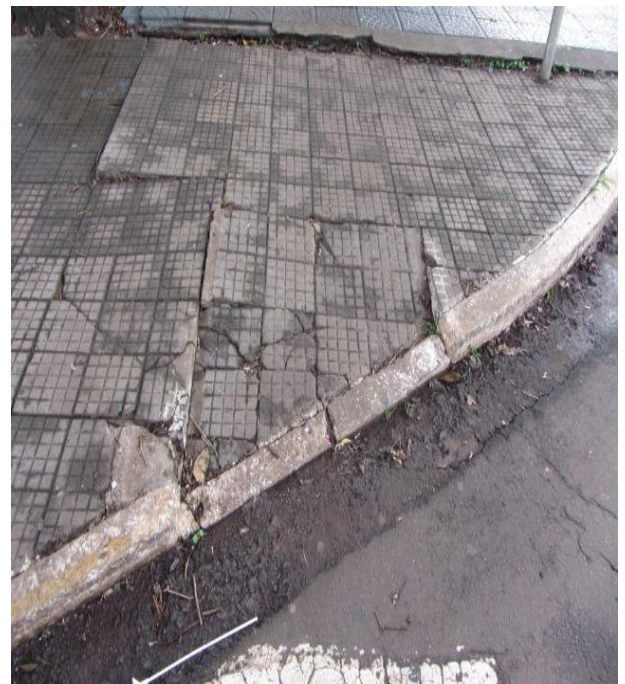
Figura 48- Rampa não conforme Fonte: autor(2014)
