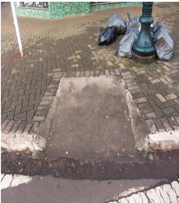
Figura 47- Rampa não conforme Fonte: autor(2014)
