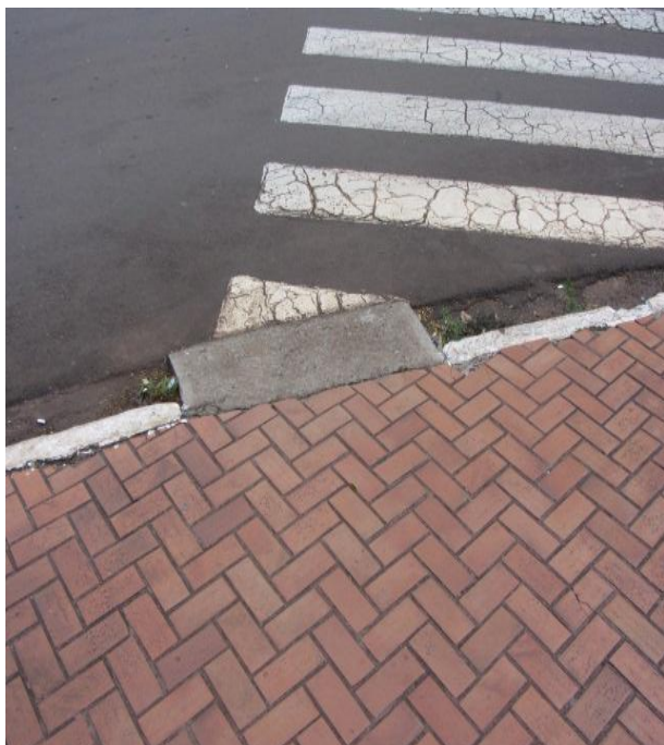
Figura 25- Rampa não conforme Fonte: autor(2014)
