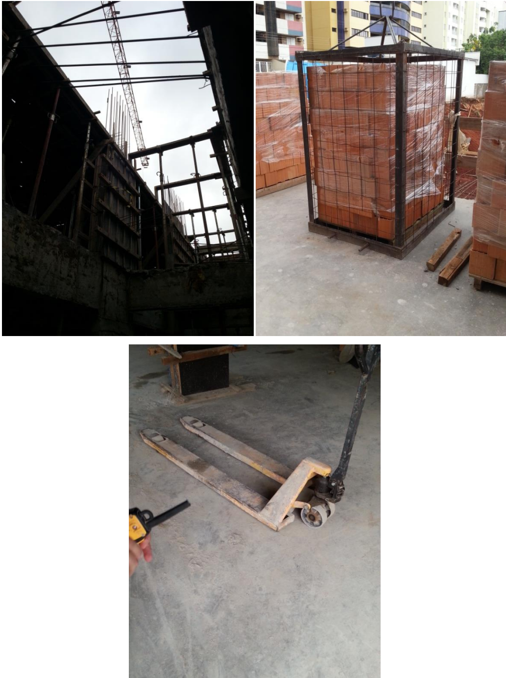
Figuras 34, 35 e 36 - Equipamento de movimentação vertical e horizontal Fonte: Autoria própria.
