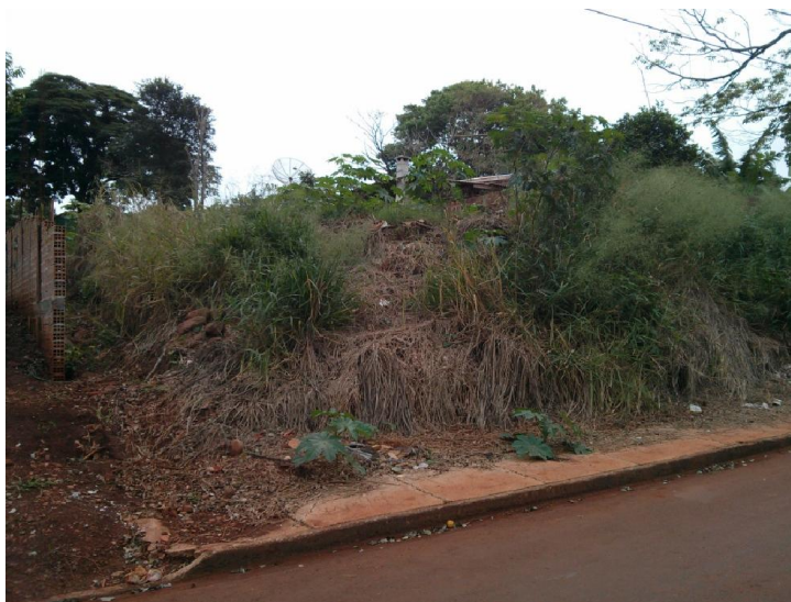
Fotografia 4 - Exemplo de obstáculos na faixa livre: vegetação cobrindo parte da calçada Fonte: Autoria própria.
