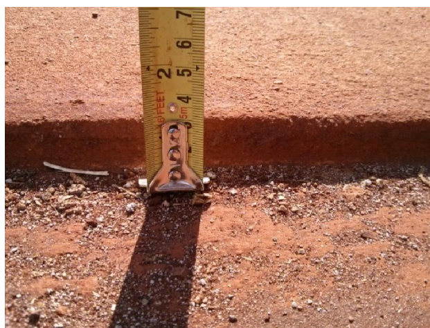
Fotografia 6 - Desnível entre asfalto e final da rampa acessível Fonte: Autoria própria.
