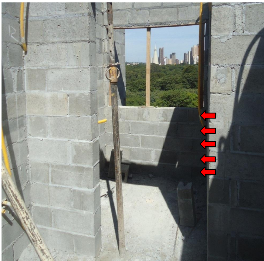
Figura 70 - Janela da área de serviço (setas indicam as cinco fiadas de blocos)
