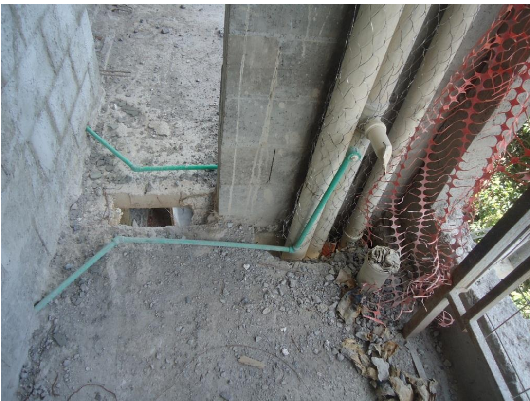
Figura 89 - Tubo de PPR de água alimentando a pia da sacada pelo chão
