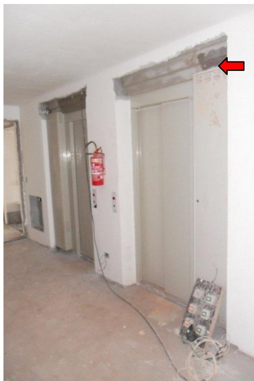
Figura 73 - Porta dos elevadores (seta indica vão entre a estrutura executada e o elevador instalado)
