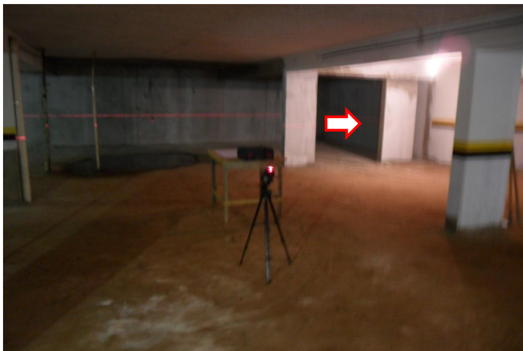
Figura 23 - Pilar 47 (seta indica a posição do pilar 47)
