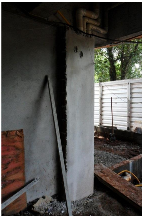
Figura 47 - Boneca na entrada do edifício para esconder tubulações hidrossanitárias
