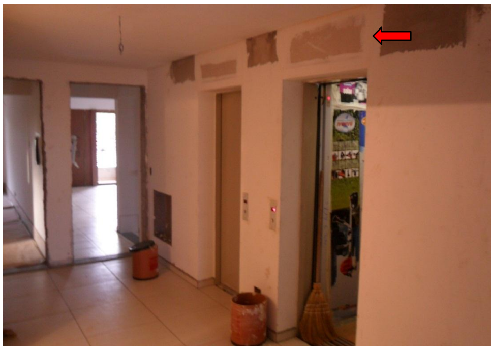
Figura 74 - Porta dos elevadores (seta indica fechamento do vão com gesso acartonado)
