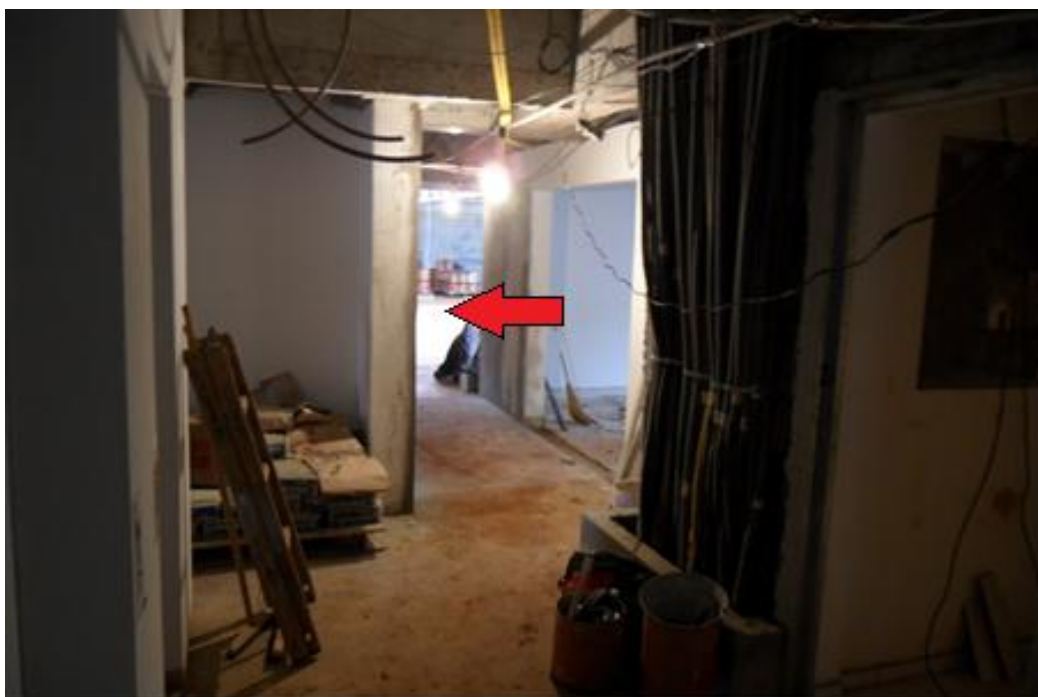
Figura 42 – Hall dos elevadores e acessos (seta indica o pilar 25 no meio da circulação)
