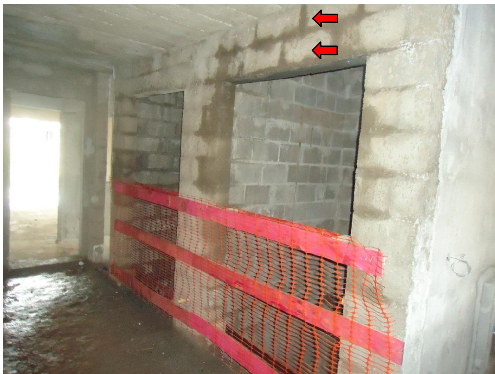
Figura 72 - Vão deixado na execução dos elevadores (setas indicam as duas fiadas de bloco-canaleta executados acima do vão)
