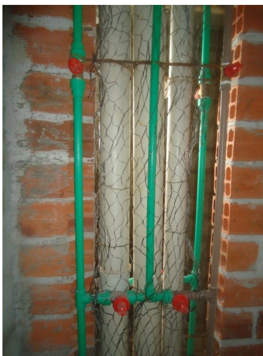
Figura 80 - Prumadas hidrossanitárias passando pela parede de vedação dos banheiros
