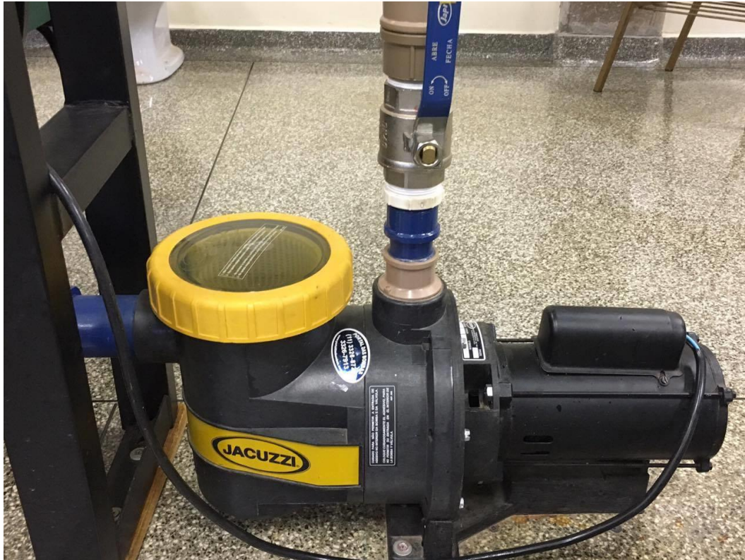
Figura 2 - Bomba utilizada no canal.
