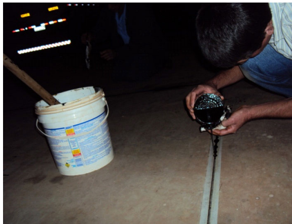
Figura 28 – Derramamento de produto sobre as juntas.
