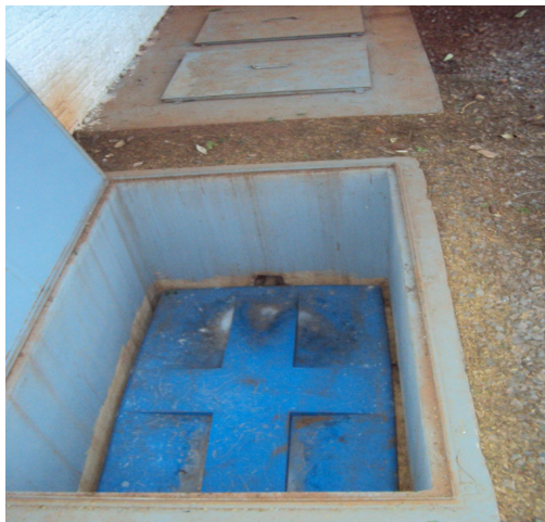
Figura16 – Caixa separadora de água e óleo.
