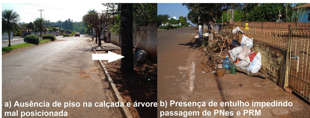
Figura 20: Ausência de piso no passeio, árvore mal posicionada, e entulho no passeio. Fonte: Dados do Autor, 2012.
