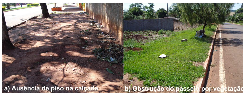
Figura 19: Ausência de piso na calçada e presença de vegetação. Fonte: Dados do Autor, 2012.
