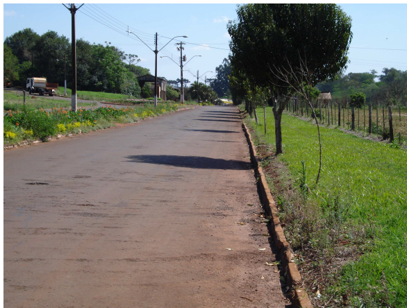
Figura 21: Ausência de piso no passeio. Fonte: Dados do Autor, 2012.
