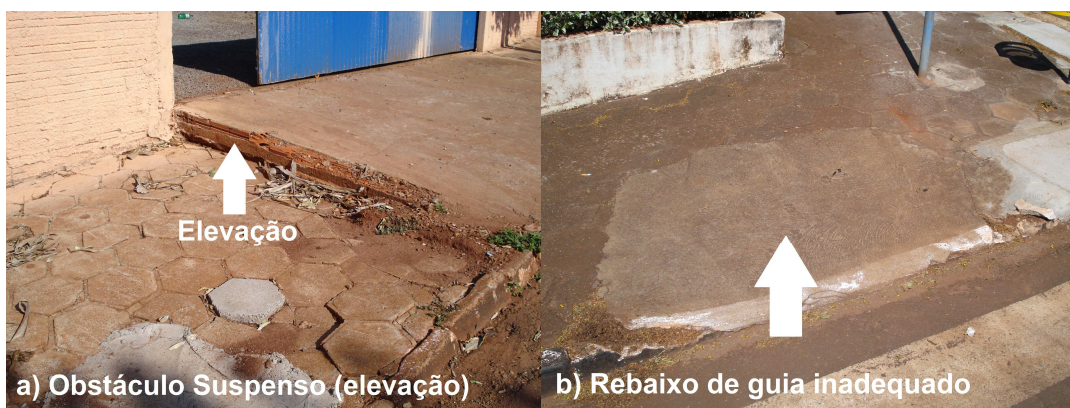
Figura 18: Presença de obstáculo suspenso no passeio e rebaixamento de guia inadequado.
