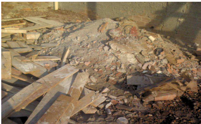
Figura 2 – Madeiras e entulhos encontrados nos canteiros das obras visitadas.
