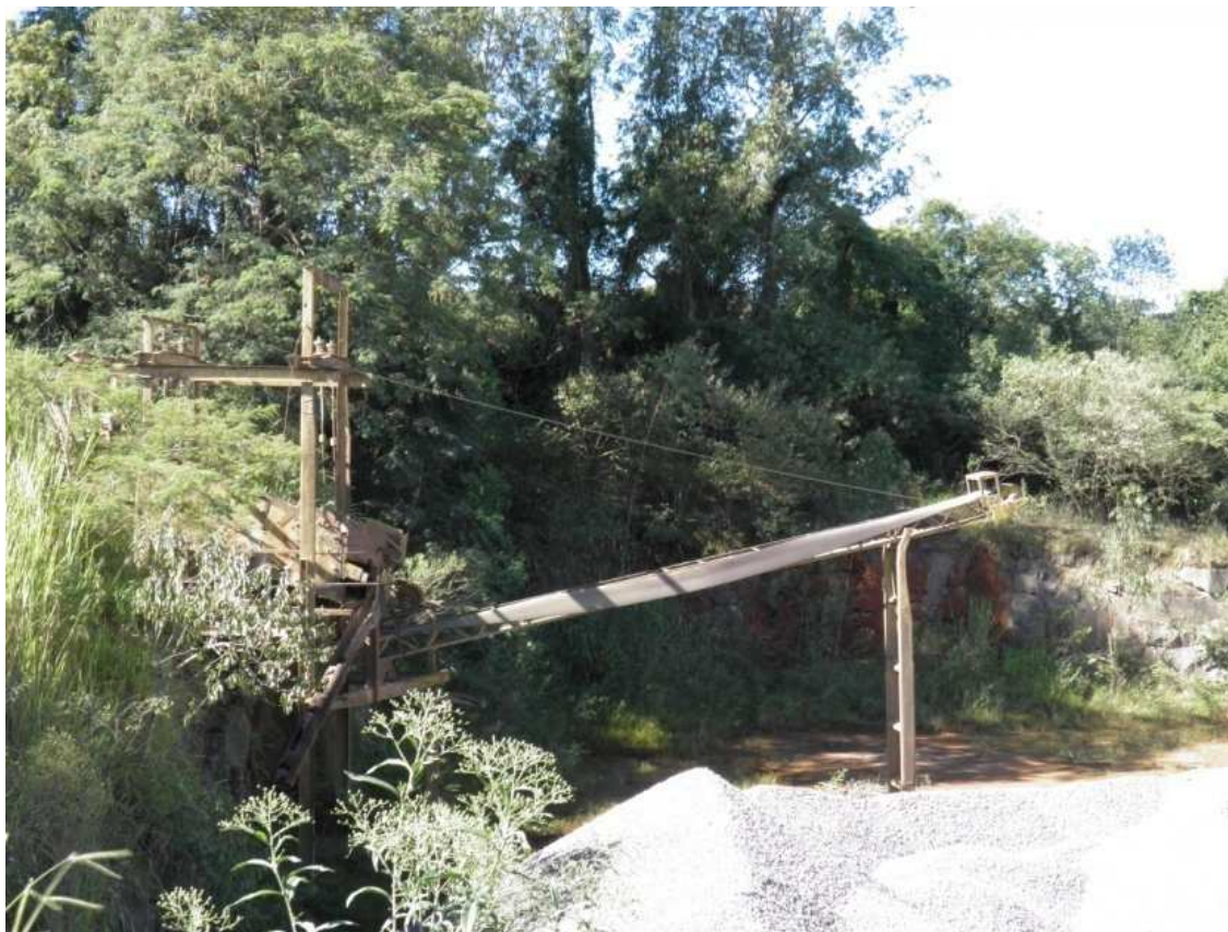
Figura 05: Esteira do Britador utilizado pela empresa A, localizada em Campo Mourão - Pr
