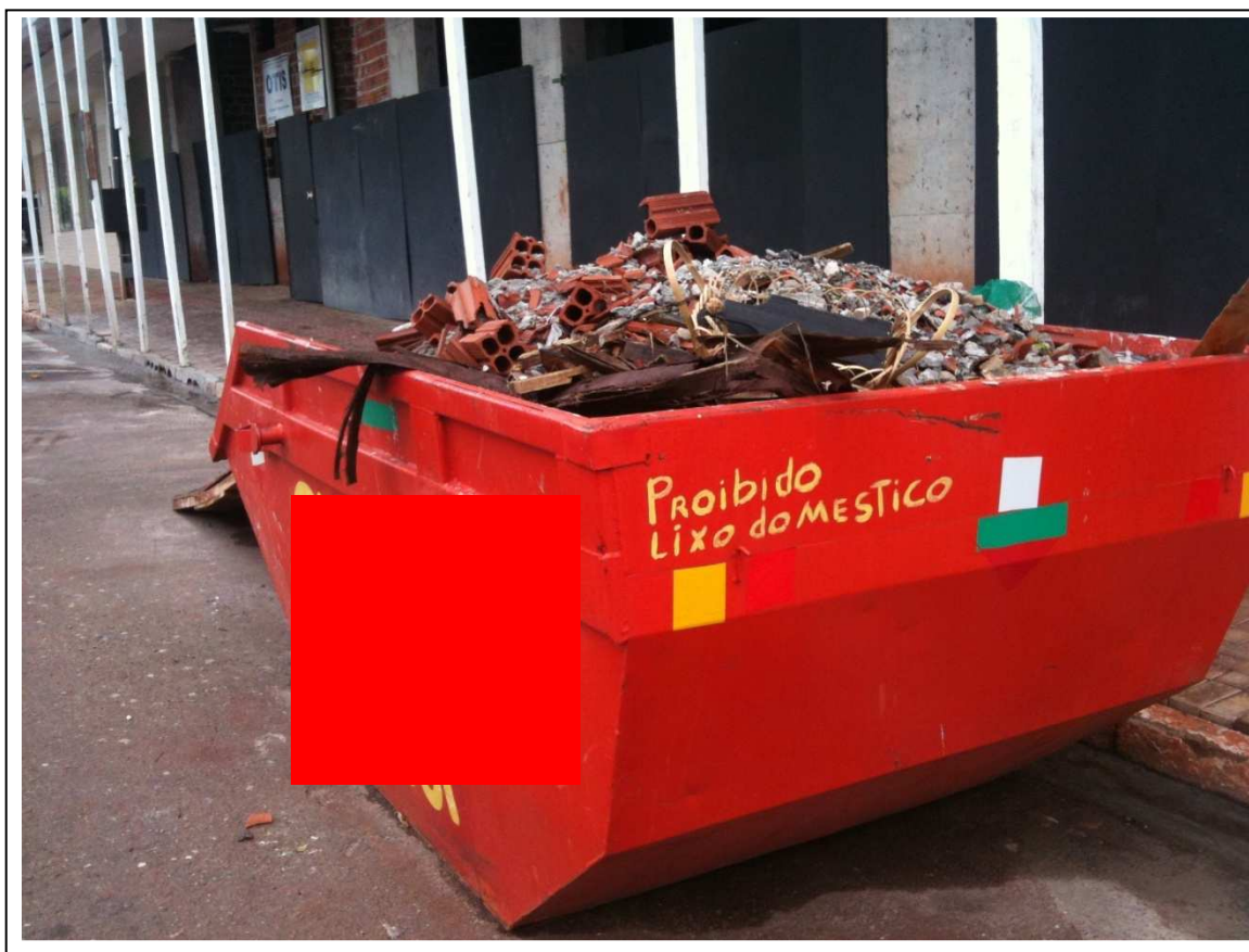
Figura 14: Resíduos da Construção Civil depositados em caçamba no Centro de Campo Mourão, Paraná.
