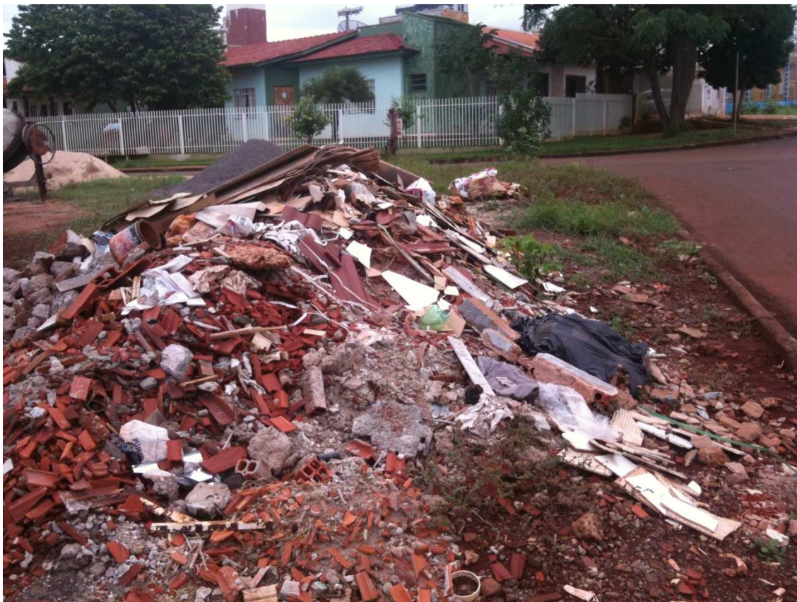
Figura 07: Resíduos da Construção Civil jogados no Centro em Campo Mourão, Paraná.
