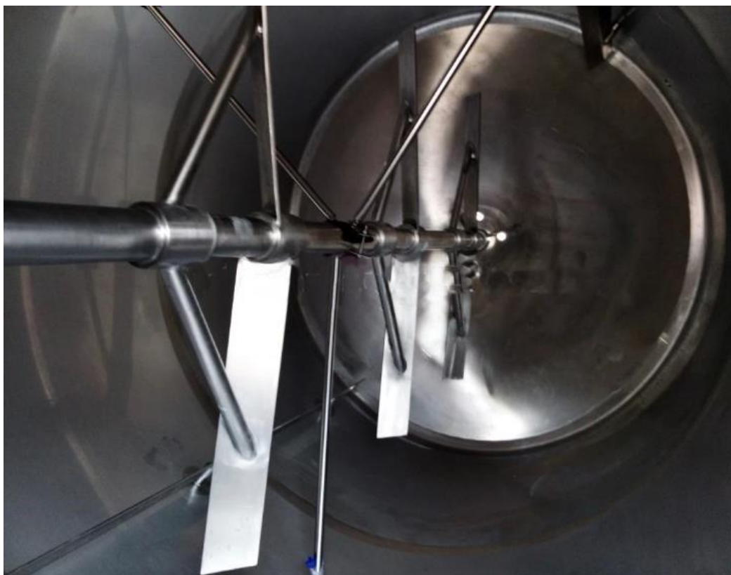
Figura 38 - Imagem ilustrativa do interior dos tanques pulmão adquiridos pela MDLGV.
