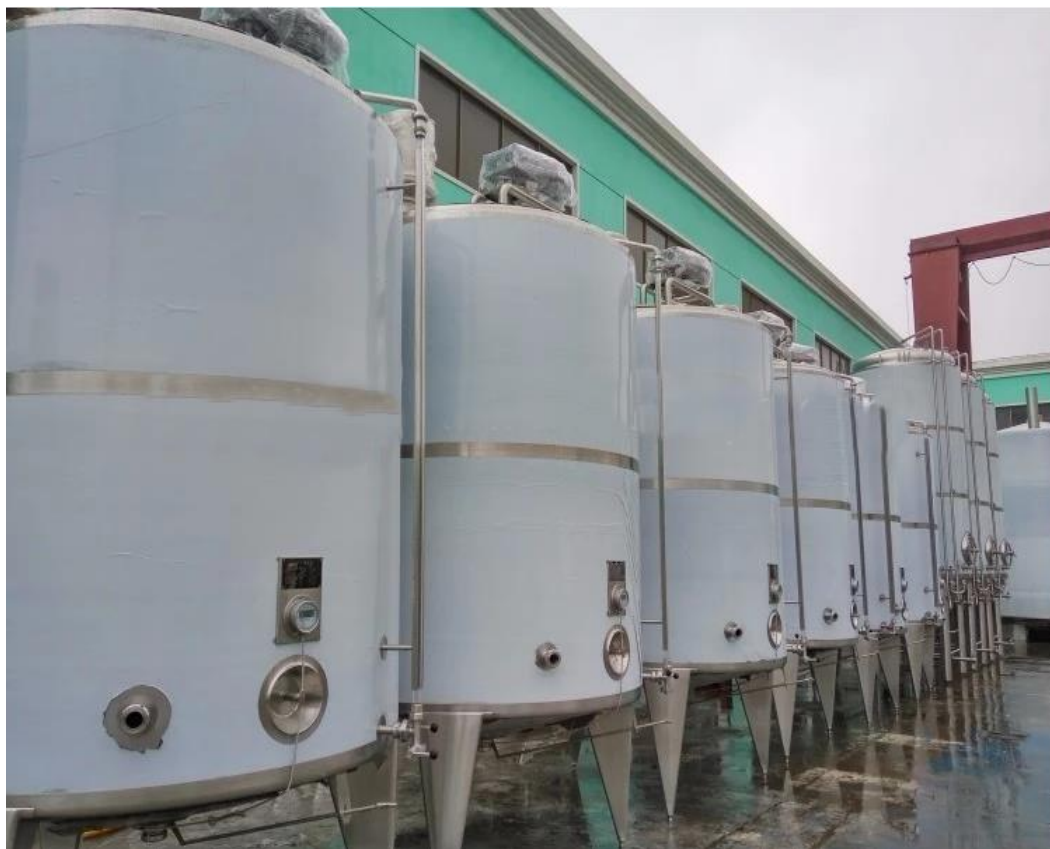
Figura 37 - Imagem ilustrativa da parte externa dos tanques pulmão adquiridos pela MDLGV.
