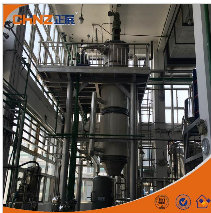
FIGURA 45 – EVAPORADOR DE TUBOS LONGOS
