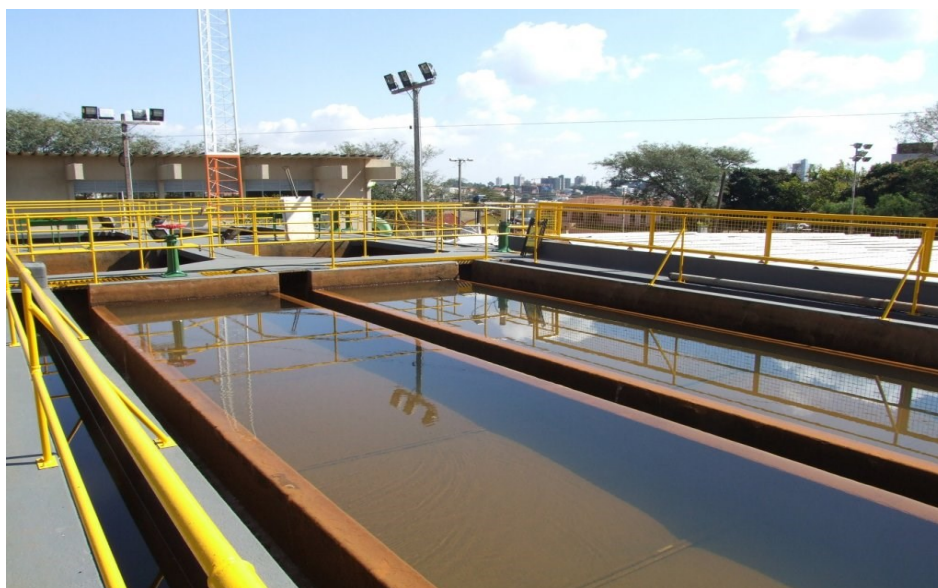
Estação de Tratamento de Água de Cascavel
