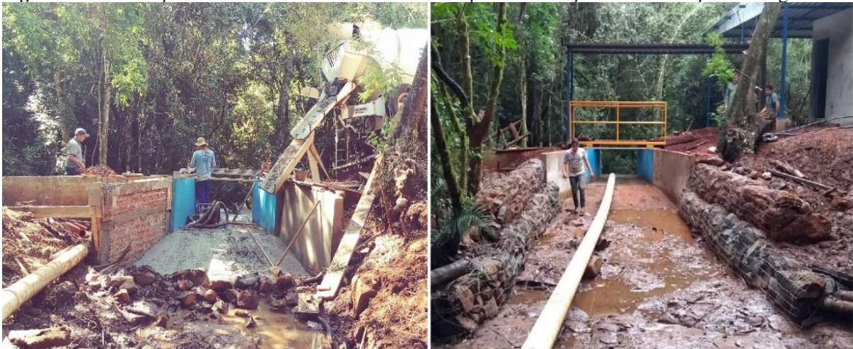
Figura 20 – Construção de muretas laterais a calha e construção de contenção de estabilização de margens.
