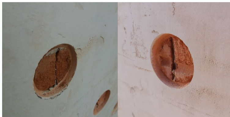
Figura 59 – Rompimento do substrato da parede executada com blocos cerâmicos sendo a) GC e b) GR
