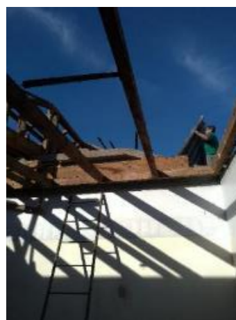
Figura 46 - Demolição seletiva de estrutura de cobertura de madeira para substituição por estrutura metálica
