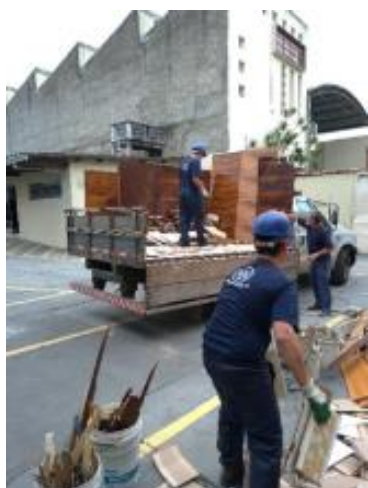
Figura 60 - Ripas, forros e chapas deterioradas ou atacadas por cupins que foram destinadas à reutilização por incineração (recuperação de energia)
