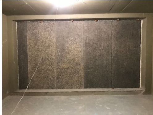
Figura 33– Vedação vertical com painéis tipo WWCB – TKS 50 mm.
