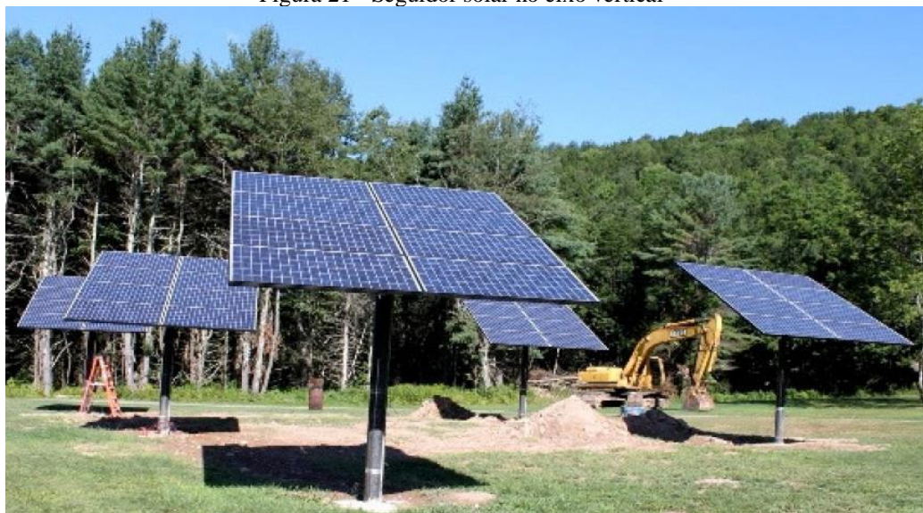
Figura 21 - Seguidor solar no eixo vertical
