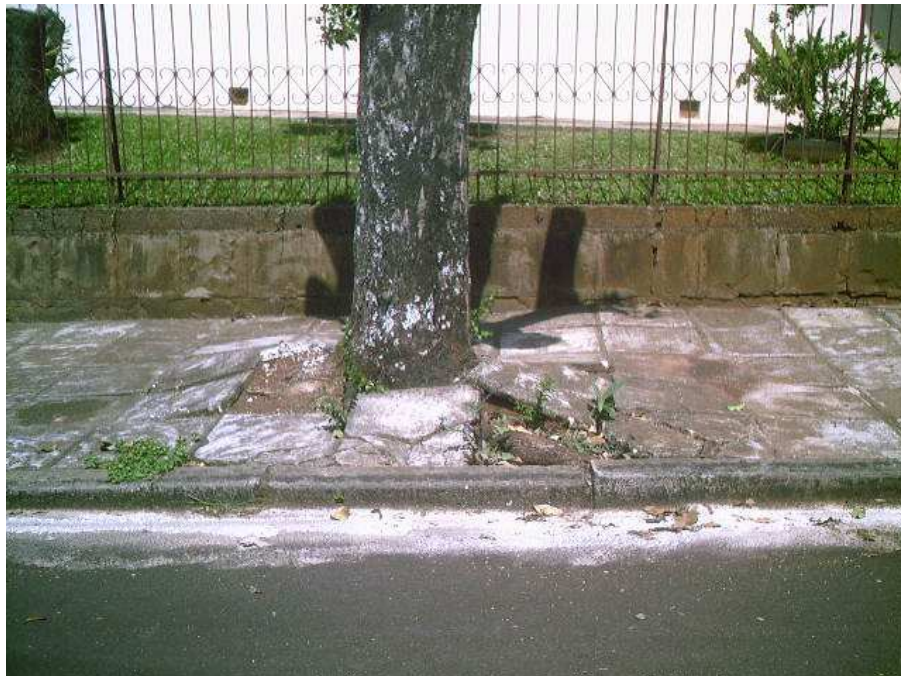
Figura 07. Calçada danificada pelas raízes da árvore no bairro La Salle, Pato Branco-PR, em função da falta de área livre
