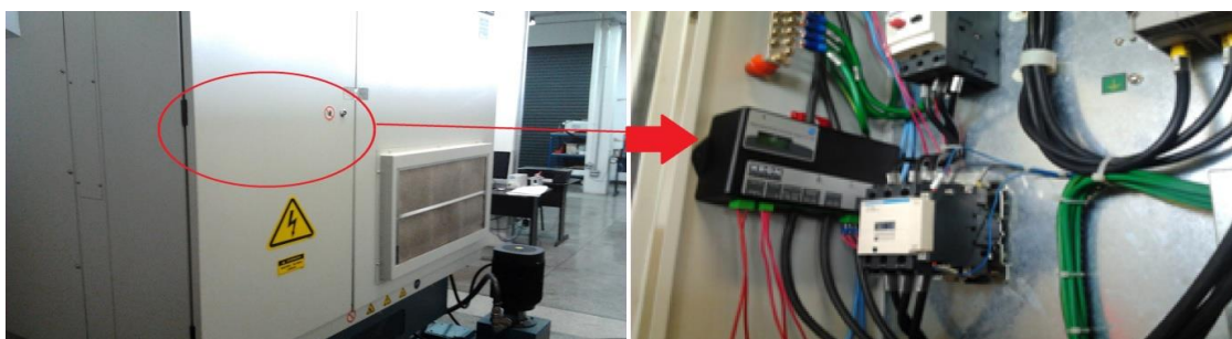
Figura 25 – Medidor de Energia e Transdutor Digital de Grandezas Elétricas Mult – K 120 da KRON® instalado no painel da ROMI D600
