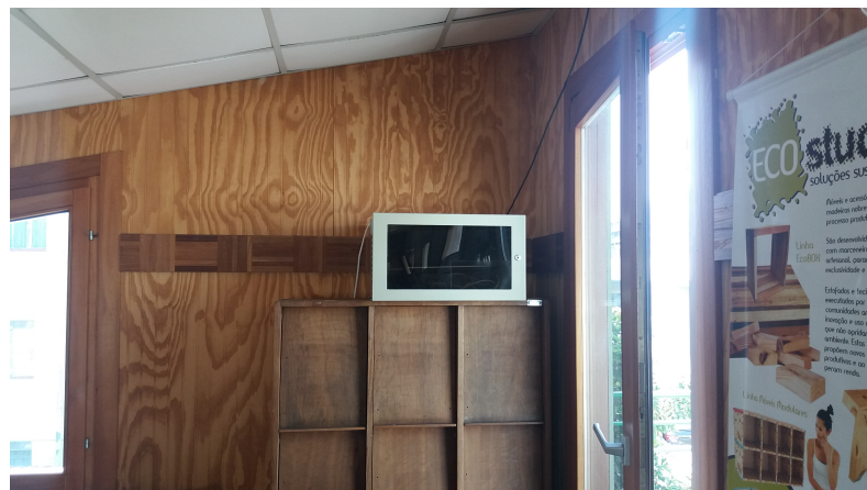
Figura 30: Localização do Rack de monitoramento.
