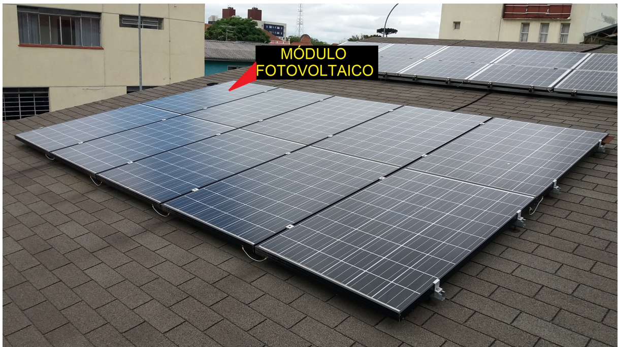
Figura 24: Planta fotovoltaica com módulo monitorado
